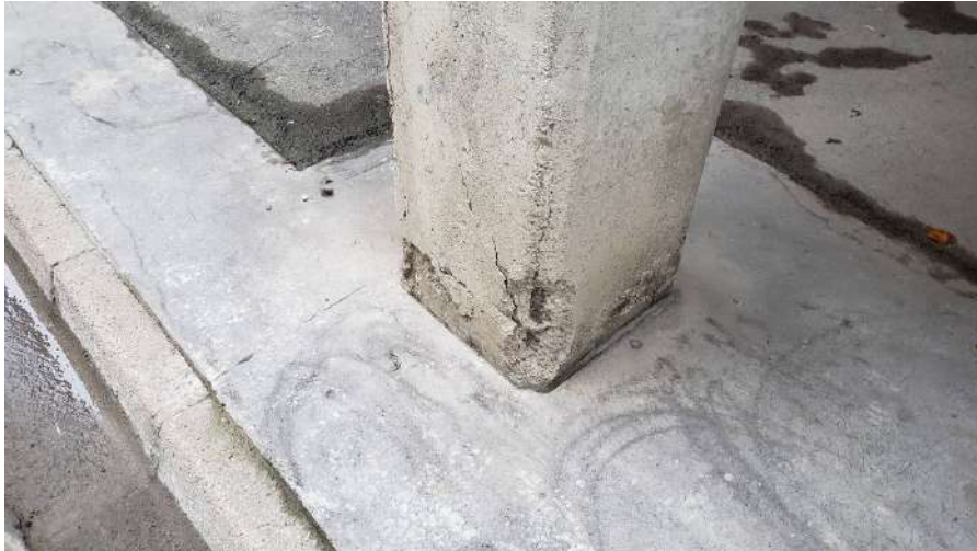
Oxidació armat longitudinal i estrebat l'arrencada pilar zona oest
