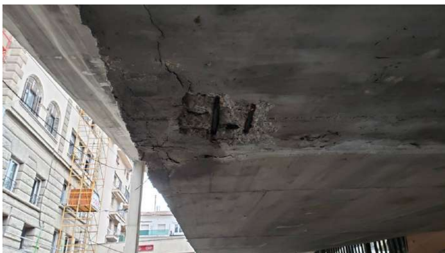
Oxidació armat inferior llosa rampa de vianants oest
