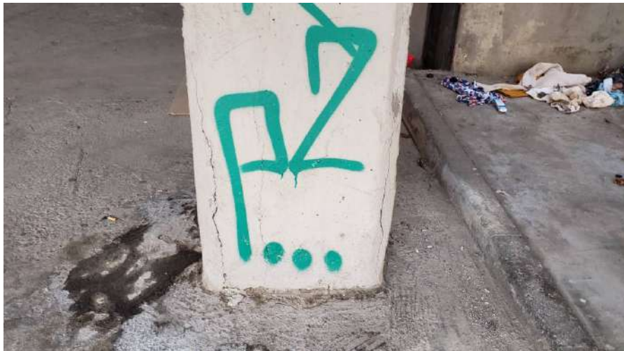
Fissures verticals a pilars, per oxidació d'armat vertical en pilar ja reparat rampa est
