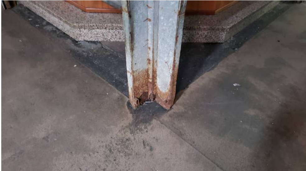
Oxidacions d'elements metàl·lics secundaris zona parades
