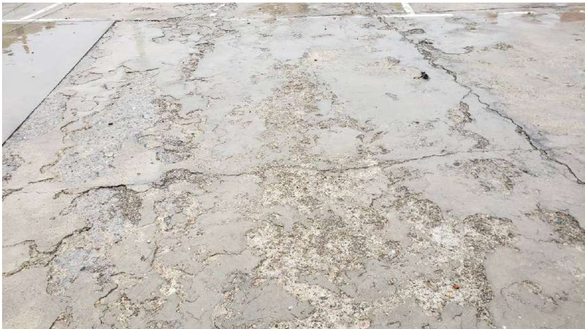
Deteriorament paviment exterior per abrasió i gelades planta coberta
