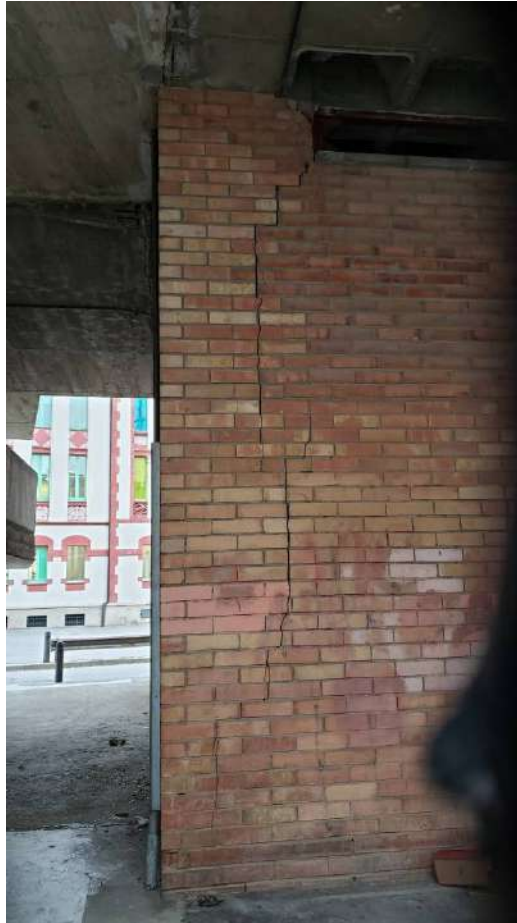
Esquerdes per compressió tancaments planta baixa zona est
