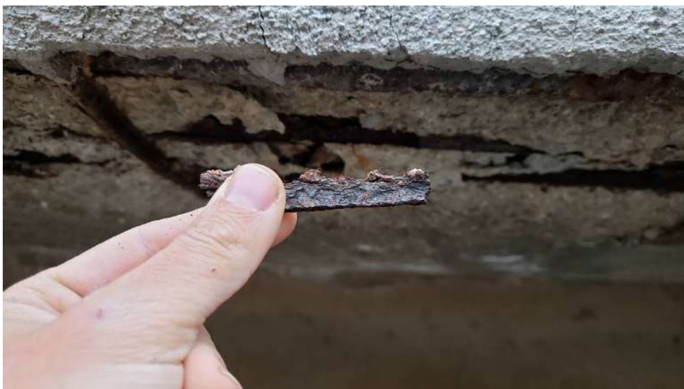
Armadura completament oxidada rampa est forjat inferior primer tram
