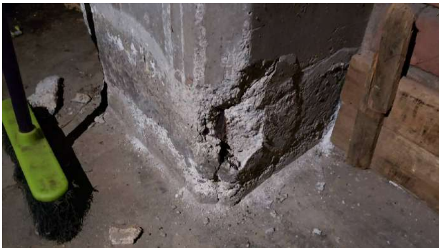
Oxidació armat longitudinal i estrobat l'arrencada pilar planta baixa interior
