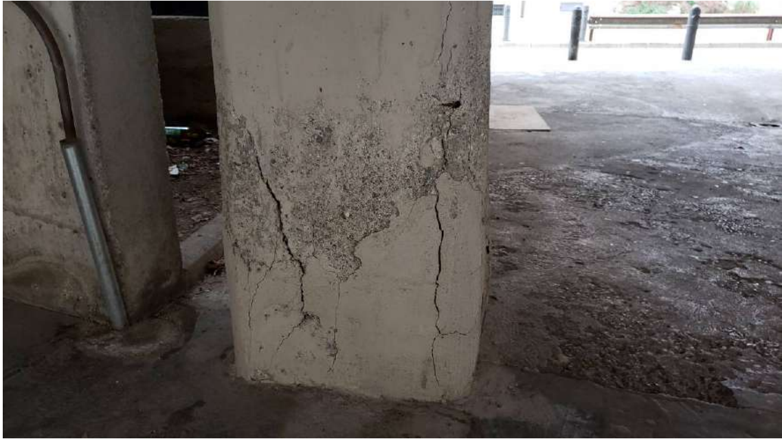
Oxidació armat longitudinal l'arrencada pilar zona est
