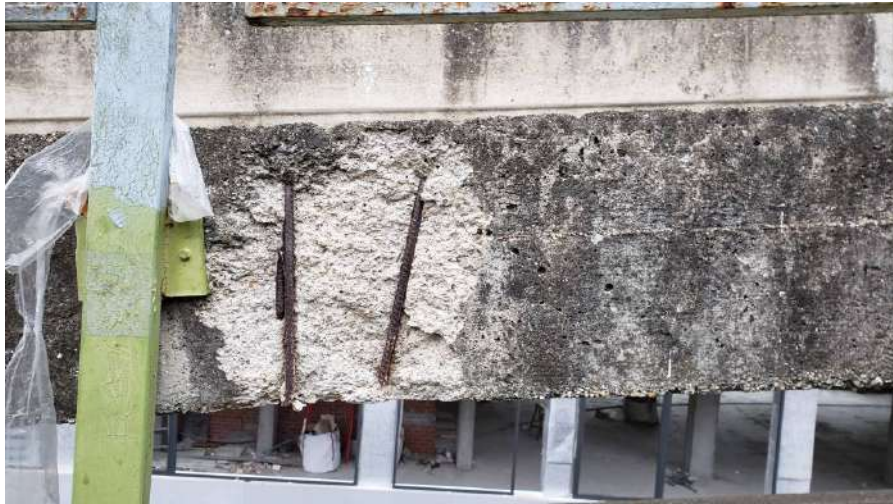
Oxidacions armat inferior llosa rampa de vianants oest
