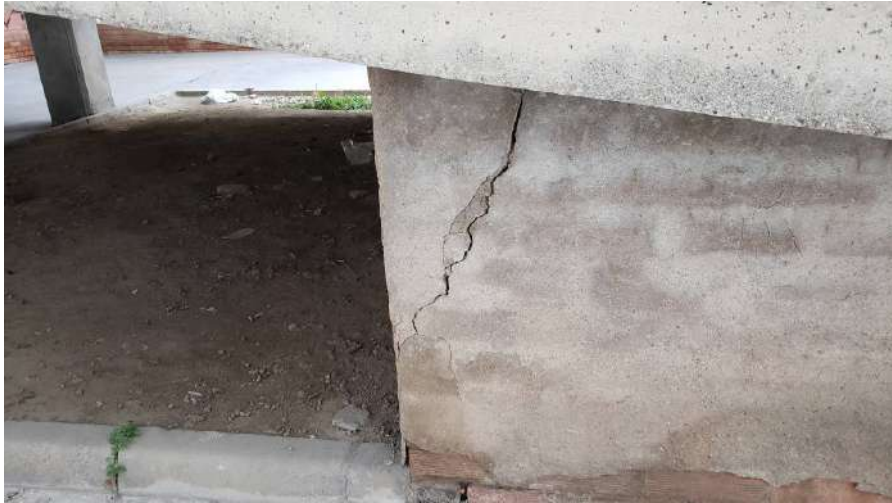
Esquerdas en tancaments obra de fàbrica rampa de vianants est inferior
