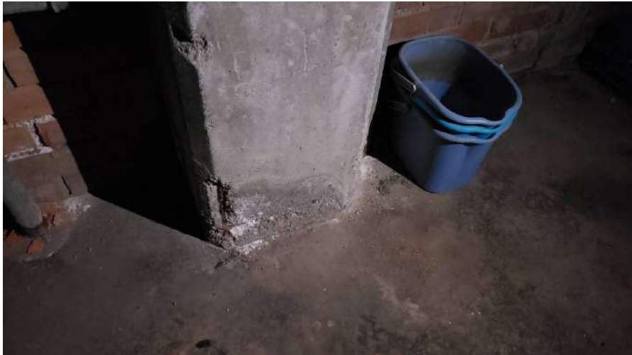
Oxidació armat longitudinal i estrobat l'arrencada pilar planta baixa interior
