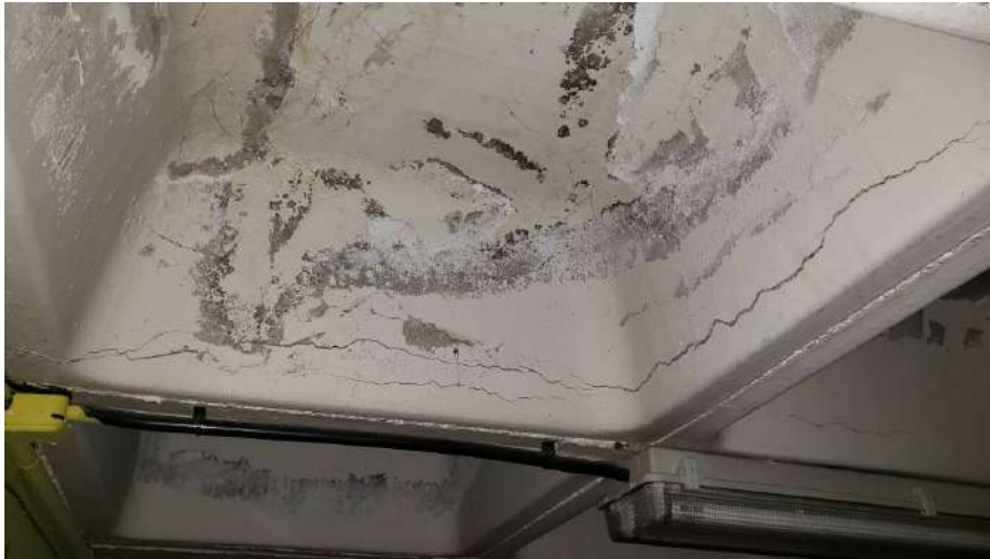
Armatures sense recobriment i fissures sotre planta baixa zona altell oest
