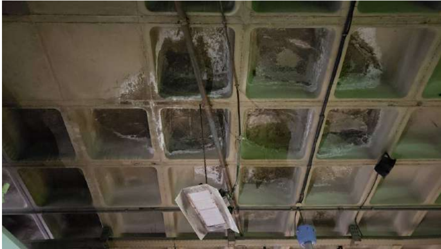
Sostre planta primera en zona humitats derivades de la coberta, zona junta dilatació.
