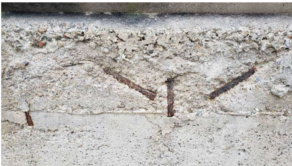
Armadures sense recobriment als testers forjat rampa est
