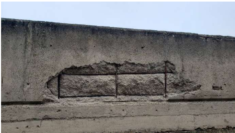
Oxidació i escrostonat formigó ampit coberta zona oest
