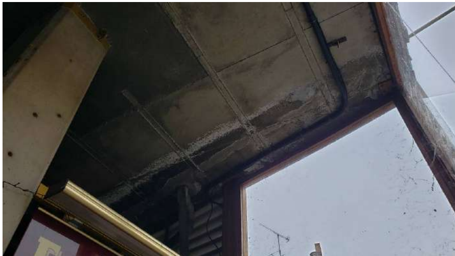
Sostre planta primera en zona humitats derivades de la coberta, especialment perimetrals.
