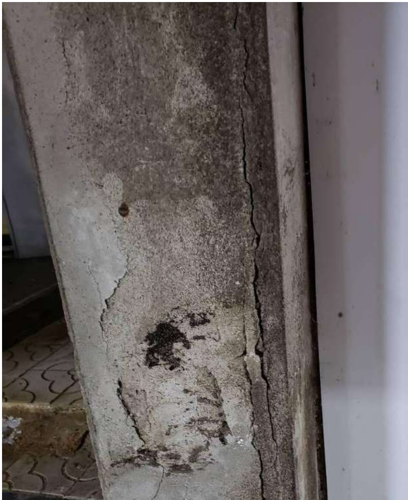
Oxidació i escrostonat formigó d'armadures longitudinals pilar planta primera zona central
