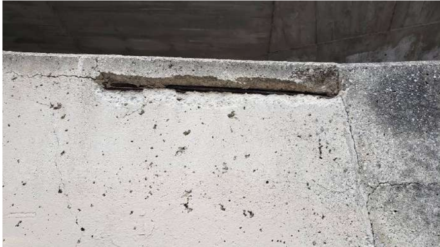
Formigó escrostonat per oxidació armadura en barana rampa est
