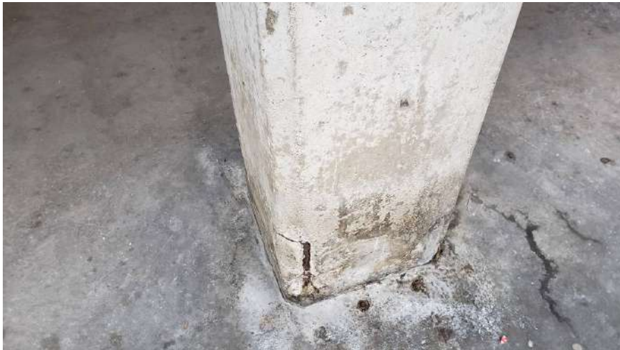
Oxidació armat longitudinal l'arrencada pilar zona nord
