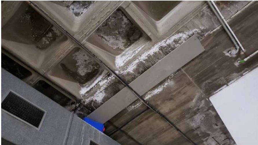
Sostre planta primera en zona humitats derivades de la coberta, zona junta dilatació.
