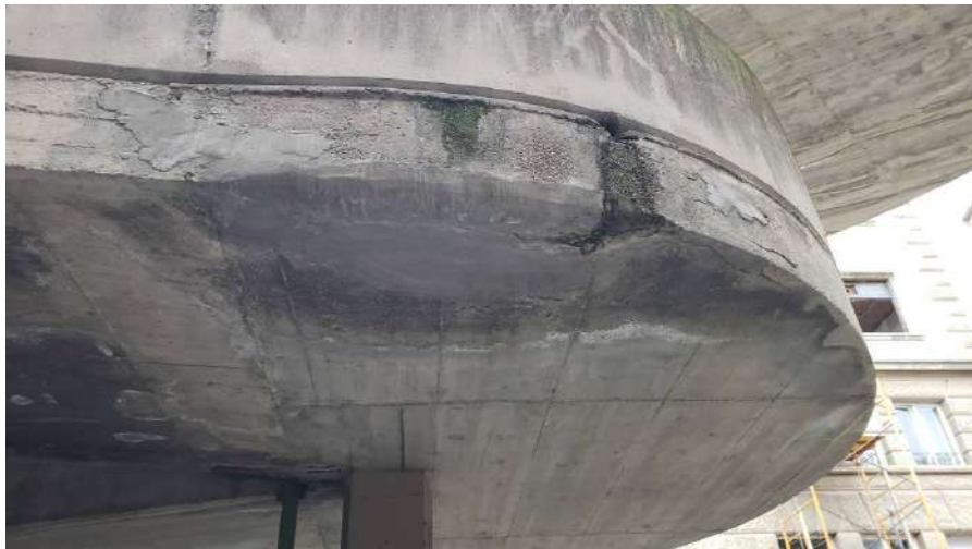
Oxidació i humitats rampa oest de vianants i reparacions antigues
