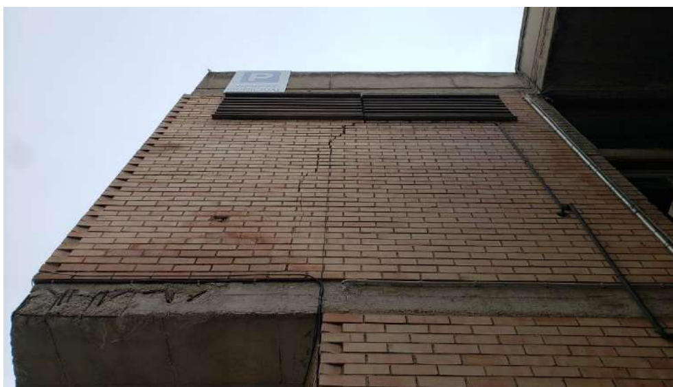
Trencament de les façanes laterals i desplom de les frontals per deformació forjat
