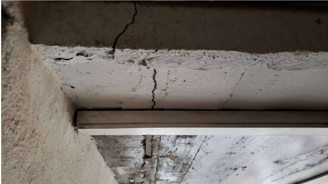
Trencaments en zona junta dilatació sostre planta primera zona nord
