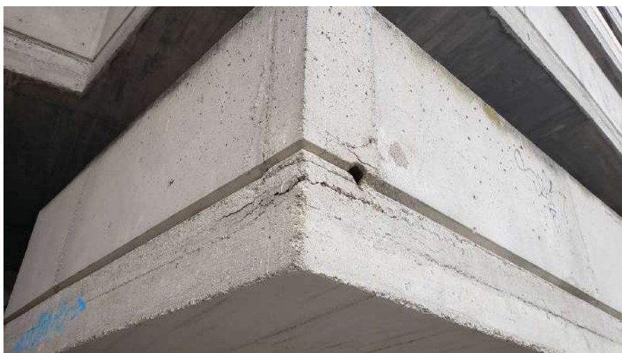
Fissures horitzontals en forjat rampa est per oxidació armat llosa
