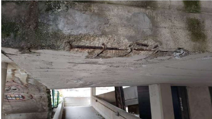
Oxidació i caiguda recobriments llosa rampa est
