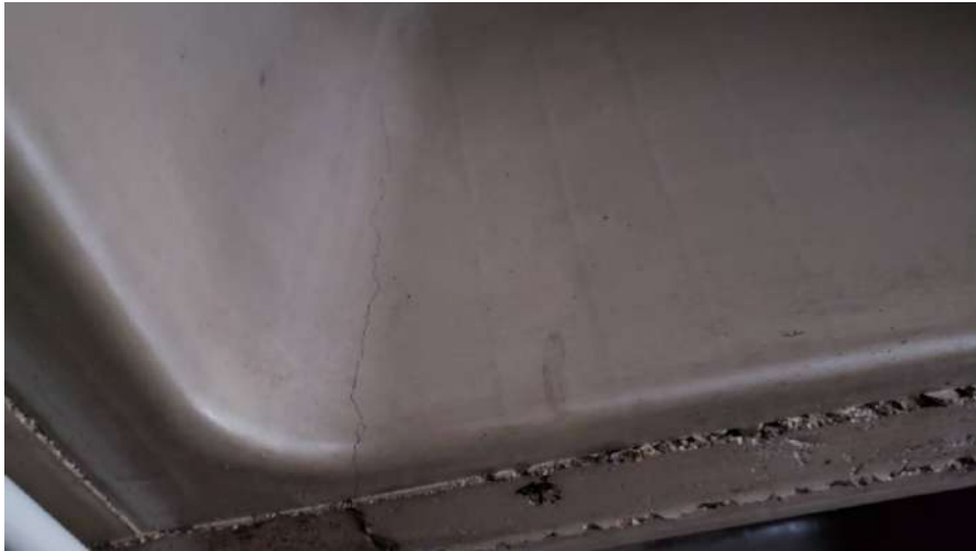
Fissures sostre planta baixa altell interior oficines (pintat)
