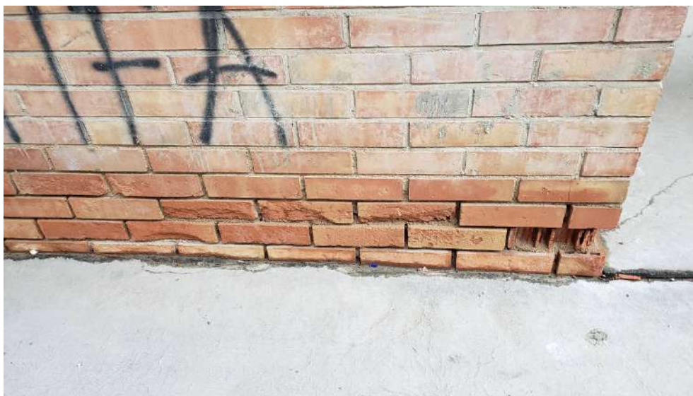
Erosió i desgast obra de fàbrica planta baixa zona sud-oest
