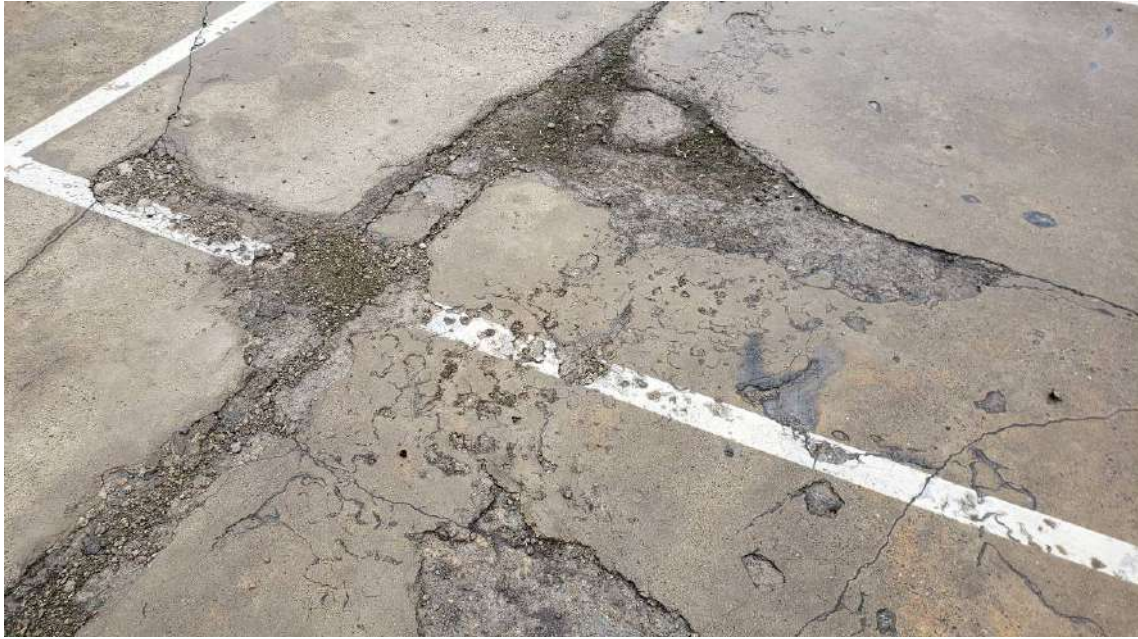
Deteriorament paviment exterior per abrasió i gelades planta coberta
