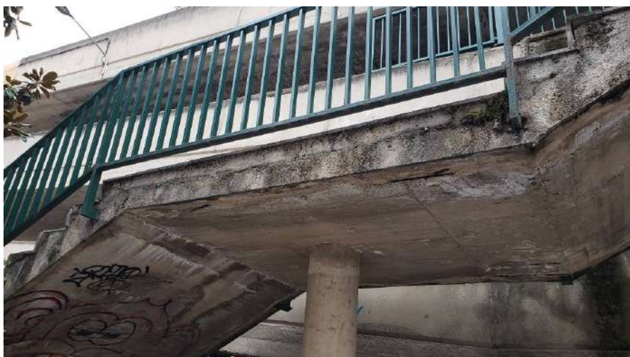
Oxidació armadures i humitats escala est
