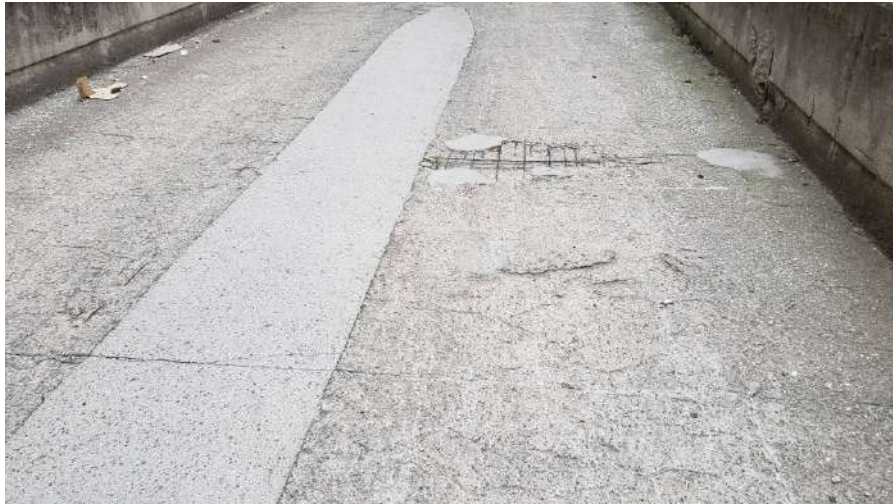
Armatures vistes en rampa cotxes oest per abrasió i escàs recobriment.
