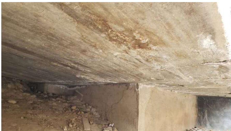
Humitats inferior rampa est primer tram i escrostonats formigó dreta
