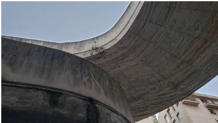
Oxidació i humitats rampa oest de vianants, inclòs vegetació
