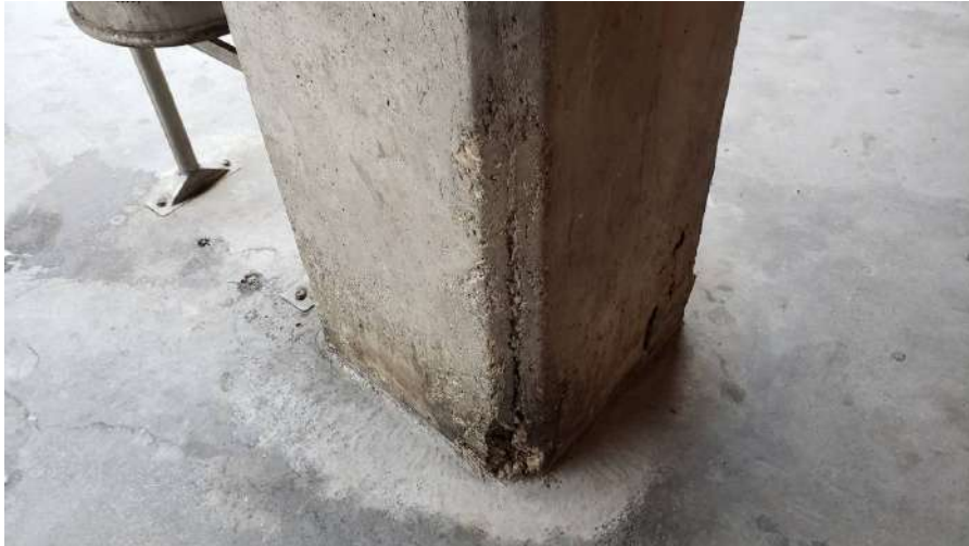
Oxidació armat longitudinal l'arrencada pilar zona nord
