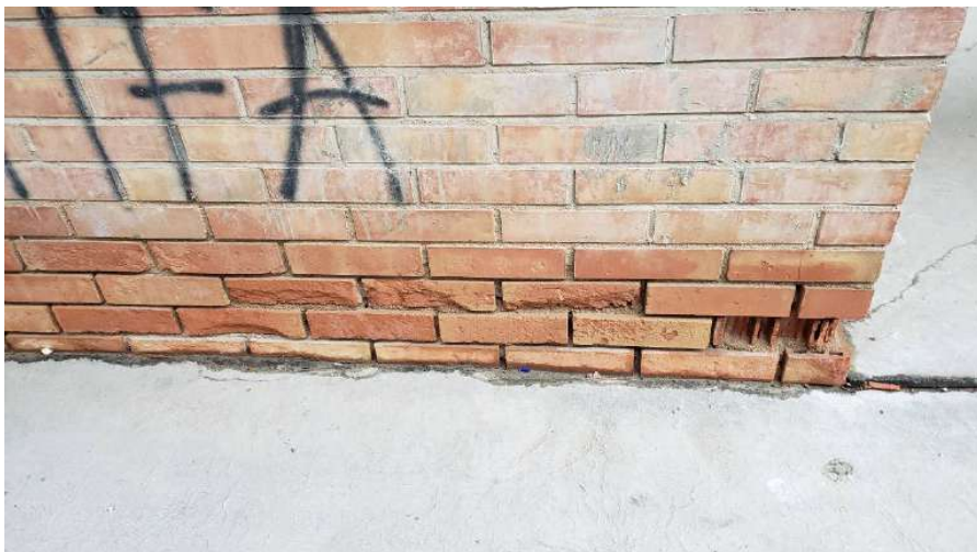
Desgast obra ceràmica planta baixa zona sud-oest
