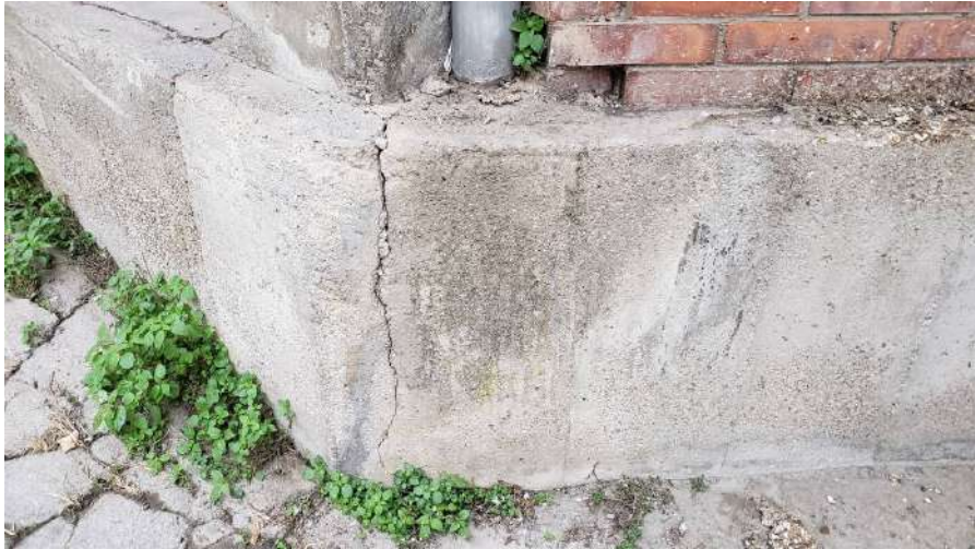
Altres fissures menors al moll zona sud
