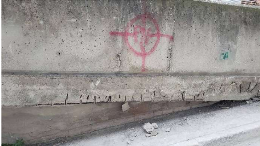
Oxidació armat cantell llosa rampa de vianants est per falta de recobriment
