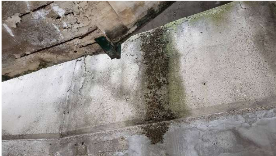
Oxidació i caiguda recobriments llosa escala est
