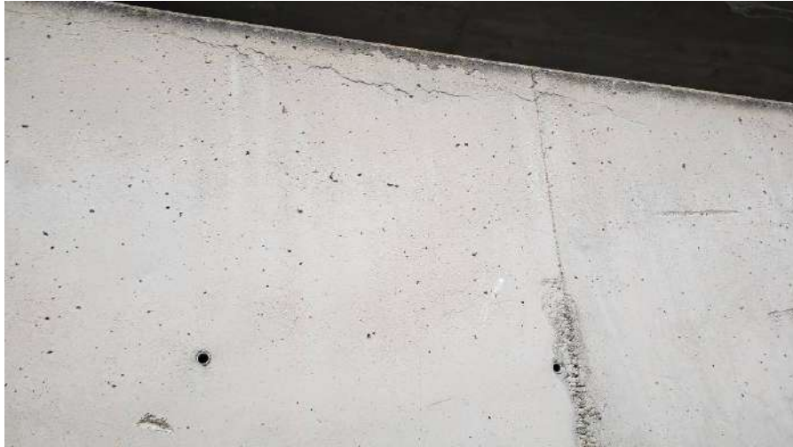
Fissures horitzontals per oxidacions d'armadures longitudinals en barana rampa est
