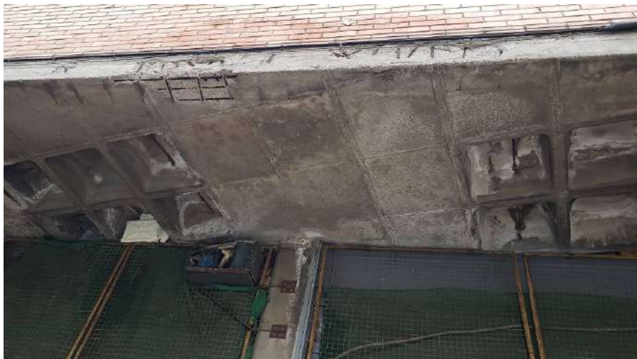
Oxidació i humitats zona sud sostre planta baixa
