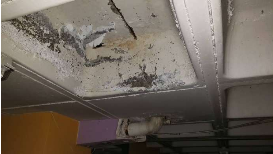
Armatures sense recobriment i fissures sotre planta baixa zona altell oest local Ajuntament
