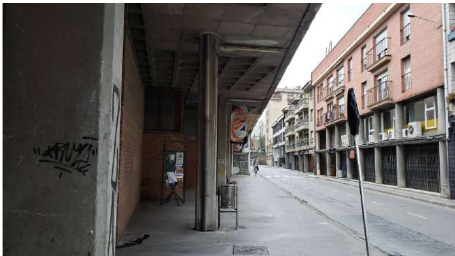
Lleugers desploms pilars exteriors, probablement constructius.
