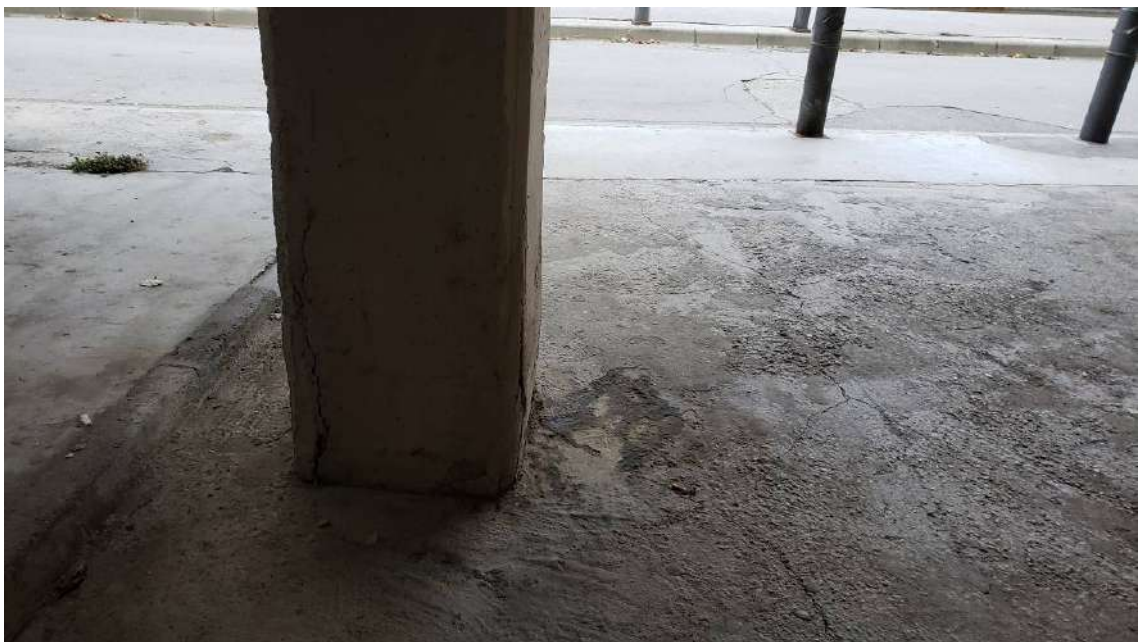
Oxidació armat longitudinal l'arrencada pilar zona est
