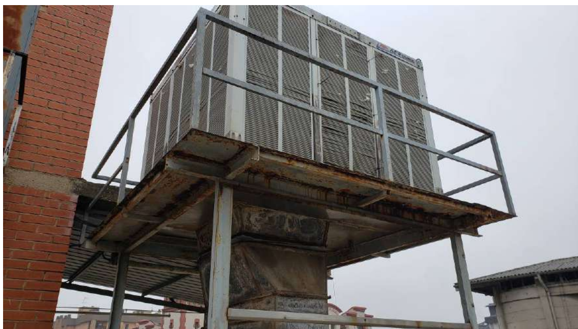
Elements oxidats estructures metàl·liques exteriors
