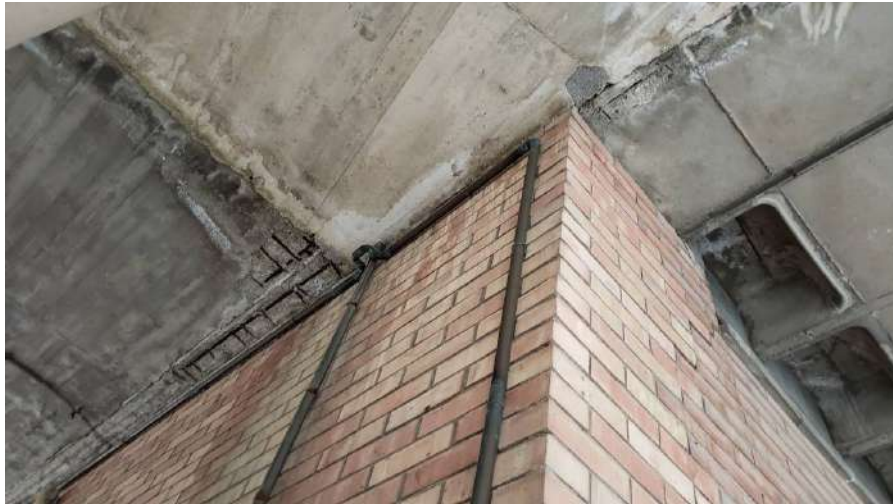
Oxidació armadures, pèrdua recobriment i humitats zona nord-est.
