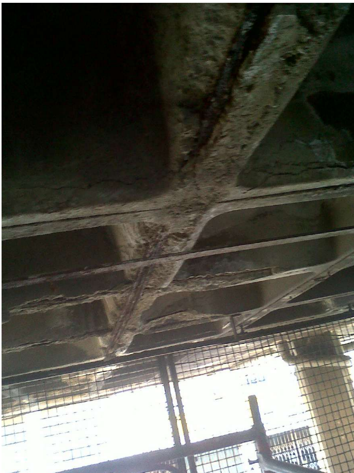
S'observa un riu amb l'armadura despenjada, s'apuntala de manera preventiva.
