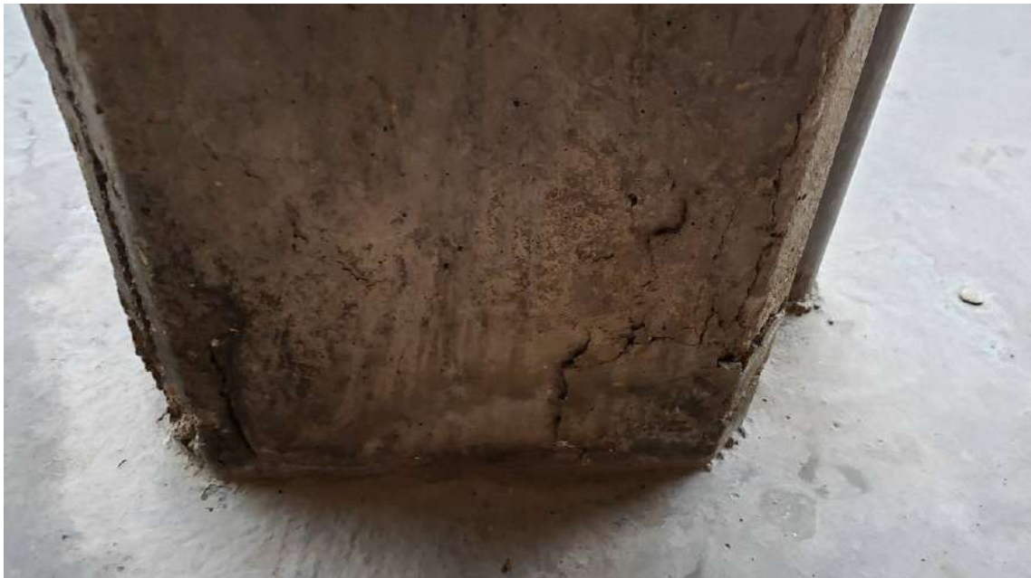
Oxidació armat longitudinal pilar zona nord
