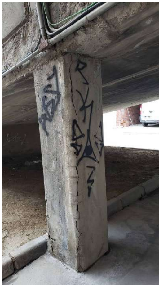
Pilar amb armat longitudinal oxidat, fissures verticals tot i reparació
