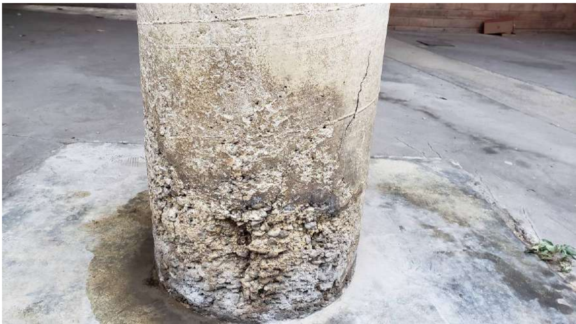
Disgregació formigó original pilar i oxidació armadures pilar escala est
