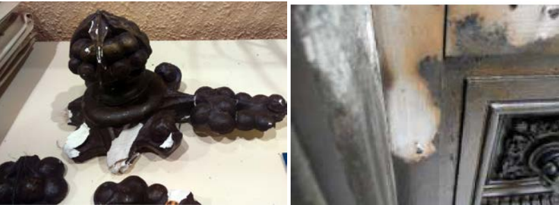
Imatges de les peces despreses. Font Arquitectura Genís Planelles
