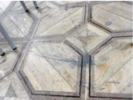
Imatges d'una zona bombada del paviment. Font Arquitectura Genís Planelles.
