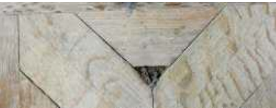
Imatges d'una junta oberta. Font Arquitectura Genís Planelles.
