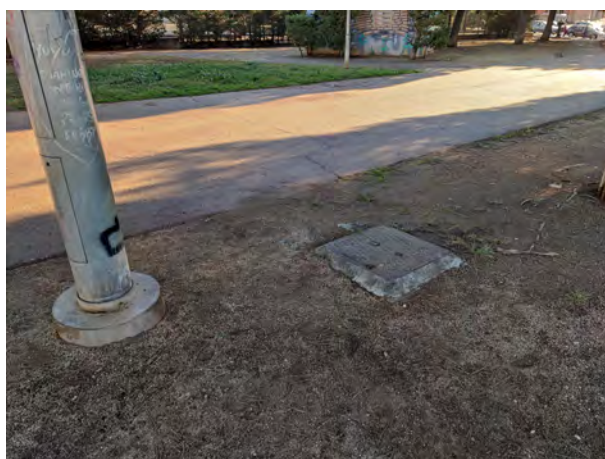
Arqueta existent de l'enllumenat públic
