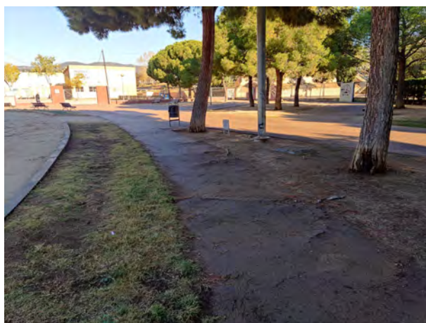
Mal estat del camí pavimentat de l'entorn
