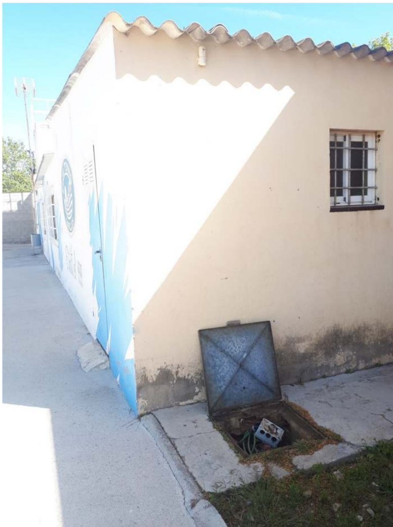
Sala Instal·lacions existents i arqueta amb corrugats existents
