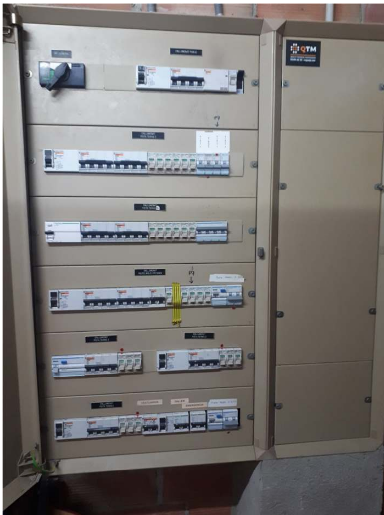
Quadre elèctric existent
