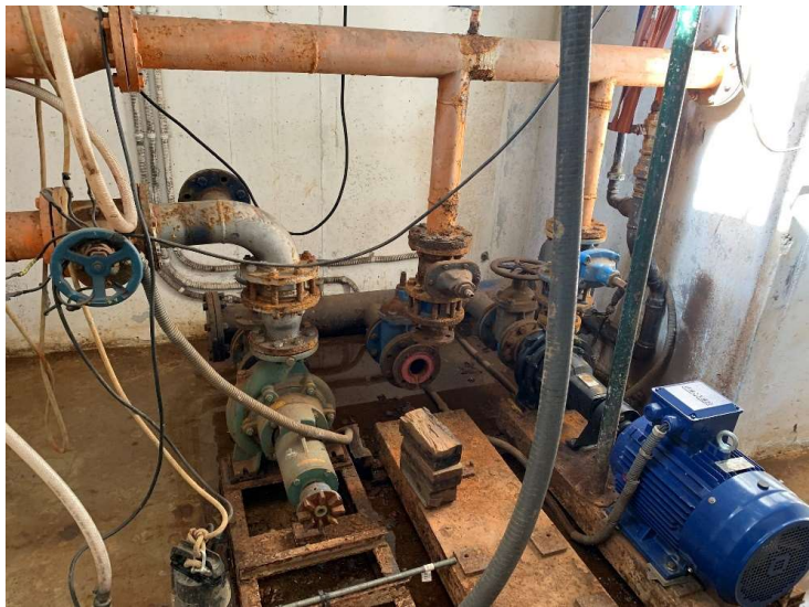
Vista del grup de bombes i canonades a la sala bombament
