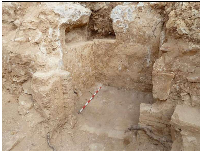
Detall de la garita localitzada en la intervenció i que correspon al petit cos de guàrdia que se situava a l'extrem del camí que comunicava el primer i el segon recinte del primitiu fortí.
