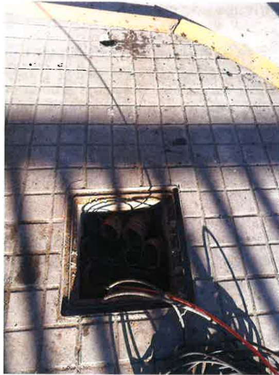
Foto 4: Detall arqueta i canalització àmbit costat mar
