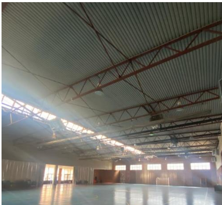
Figura 3. Imagen del estado de la cubierta del pabellón.
