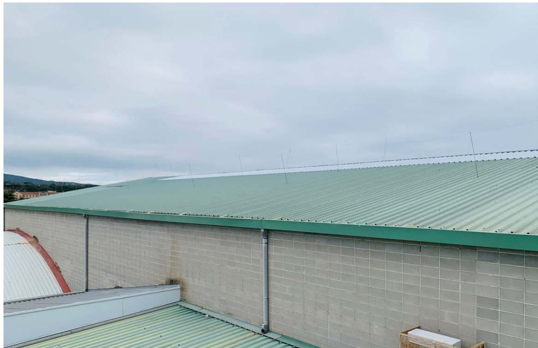
Fotografia 5: Coberta principal a substituir i reforçar
