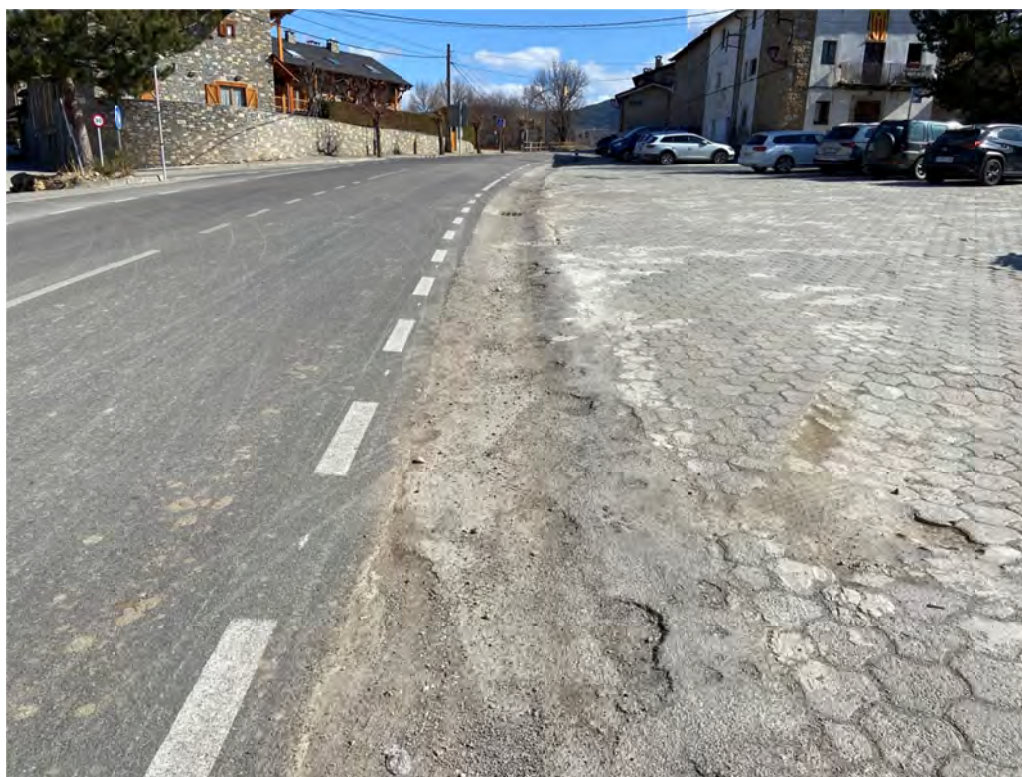
Fotografia 4. Cuneta llindar entre carretera LP-4033b. Deteriorament llamborda central.
