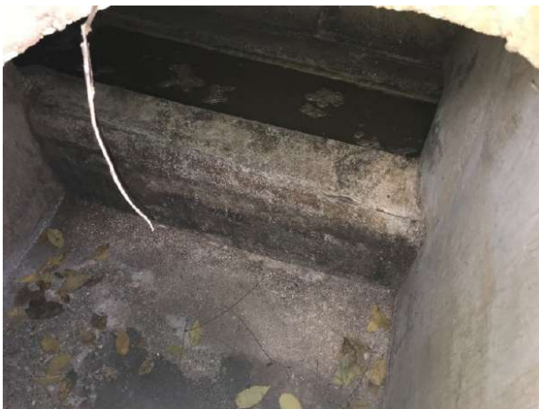
Foto 2 Sobreeixidor del pou, sense cap sistema de retenció de sòlids gruixuts i flotants.
