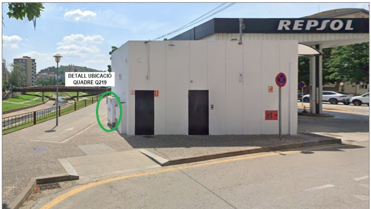
Imatge 21: Detall ubicació quadre d'enllumenat referència Q219 carrer Font del Rei.
