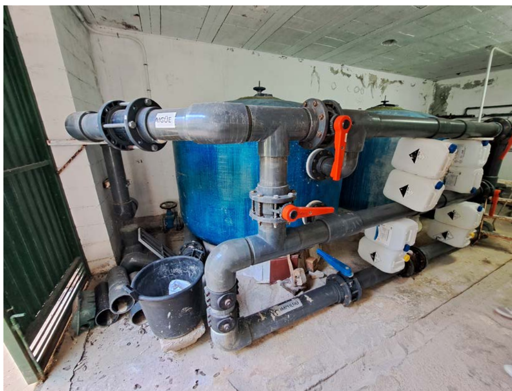
5. Piscina municipal. Vista dels filtres de tractament del vas gran a substituir.
