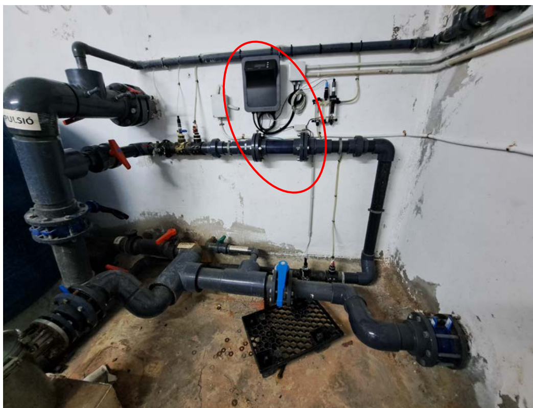
6. Piscina municipal. Vista general de la cèl·lula d'electròlisi i del controlador (cercle vermell) de la cloració salina del vas gran a substituir.
