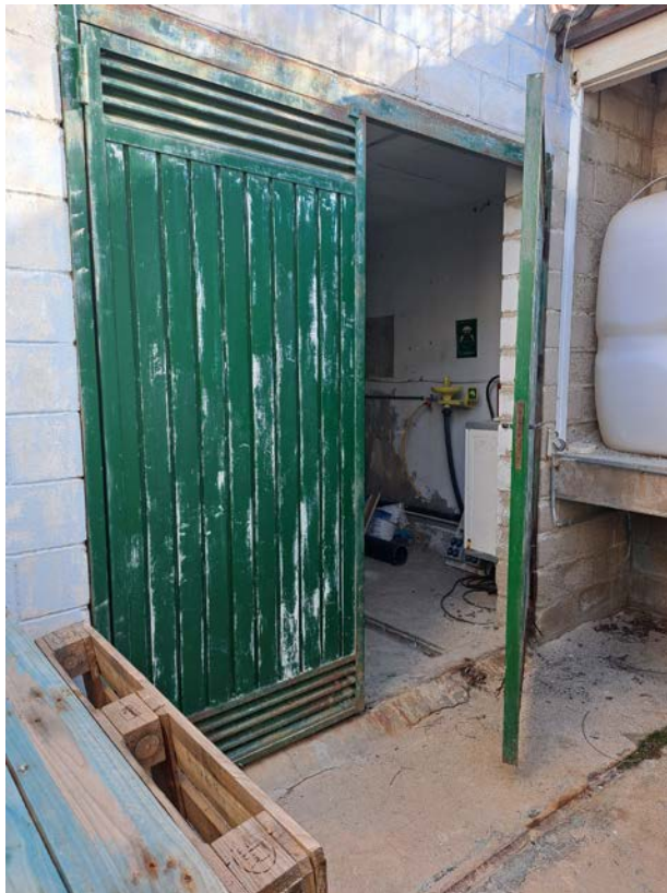
3. Piscina municipal. Vista de l'accés a l'interior de la sala de maquinària i tractament
