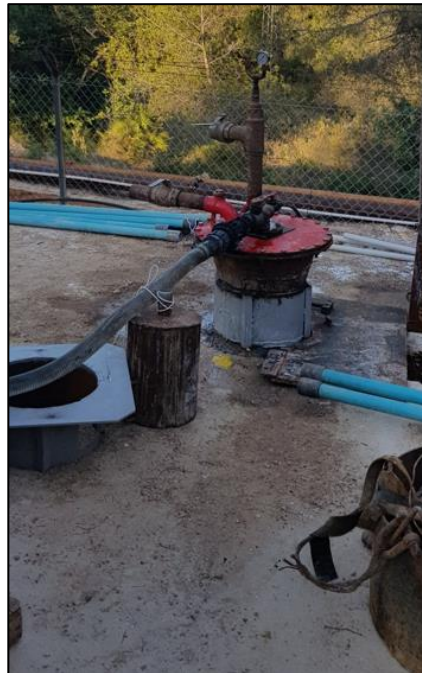
Imatge 10. Capçal de pressió soldat a la canonada del pou i valvuleria de seguretat
