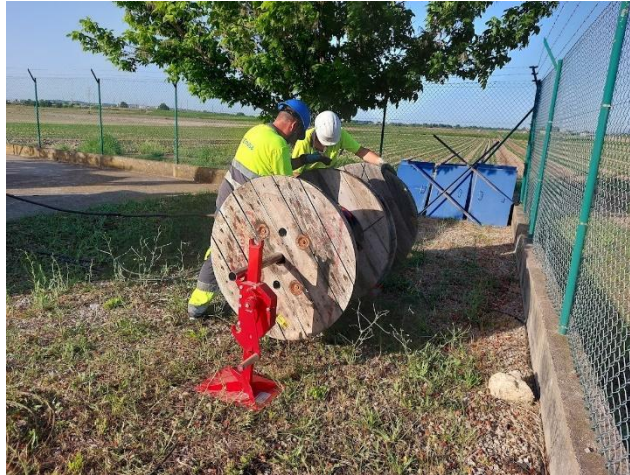
Imatge 2. Rul·los per al cable elèctric
