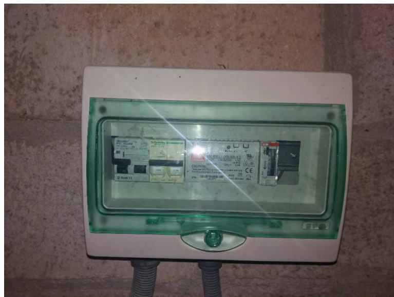
Foto 9: Quadre elèctric amb rellotge programat per injecció de clor.
