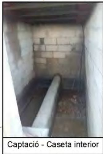
Caseta captació X: 373.978,30 Y: 4.686.628,39 Z: 1.052,15
