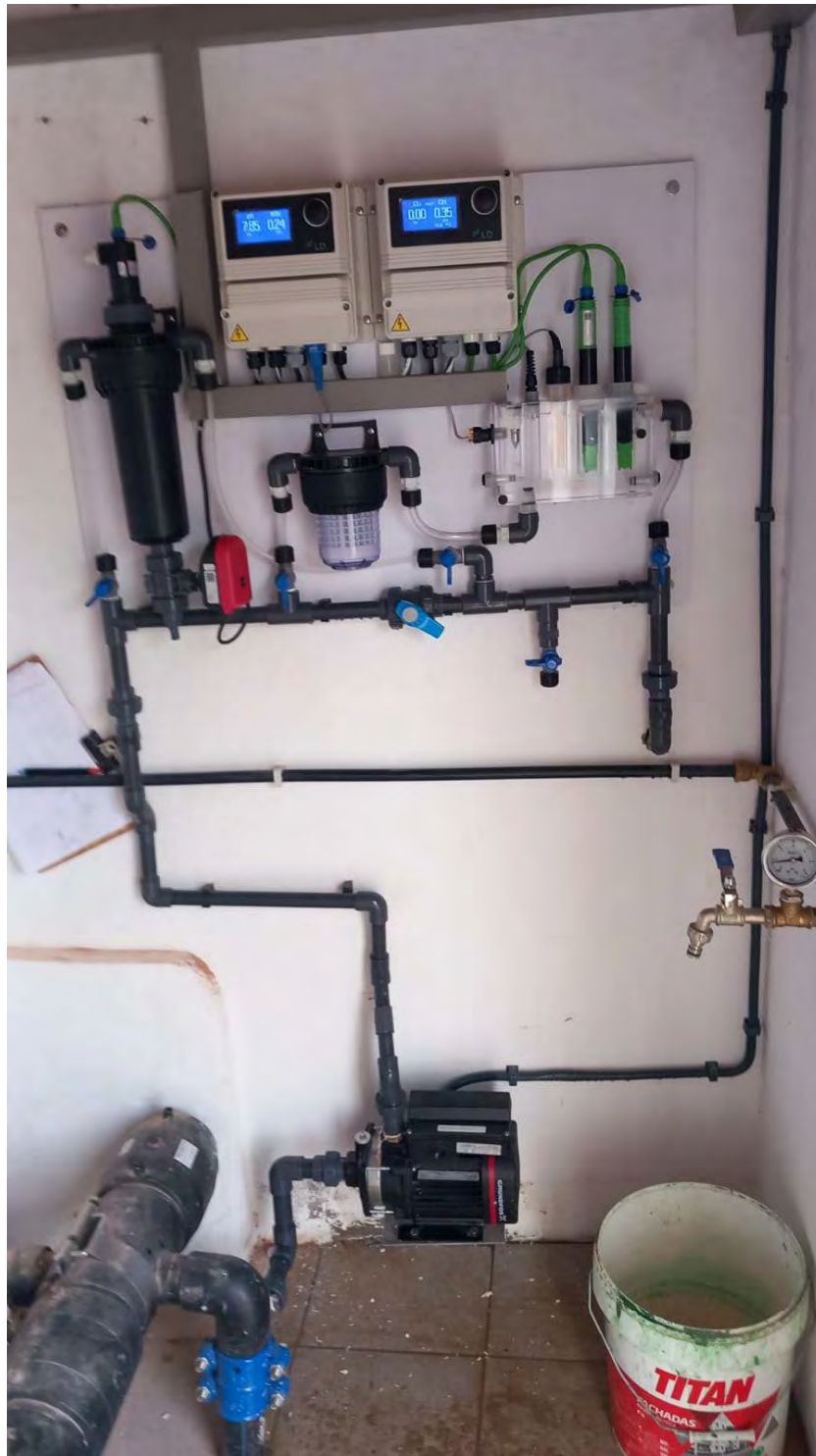
Detall equips a instal·lar en la caseta de baix del dipòsit.
