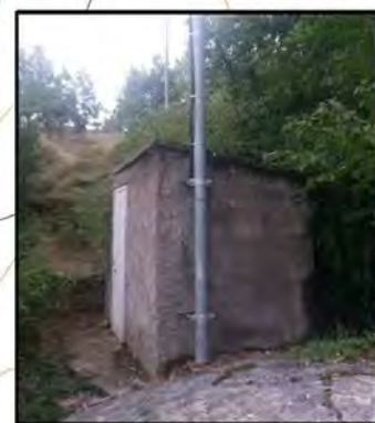
Dipòsit 1 Caseta de cloració
