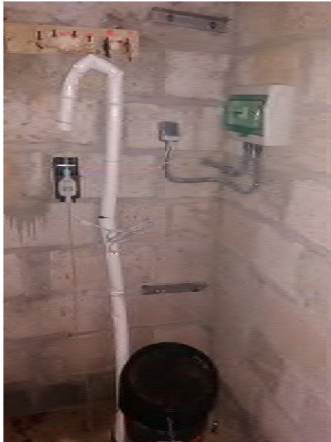
Foto 8: Interior de la caseta superior: dipòsit i bomba dosificadora de clor.
