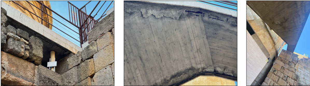
VISTES DE L'ESCALA 1 D'ACCÉS A LA TERRASSA SUPERIOR DESDE LA PART INFERIOR PER VEURE L'ABAST DE LES PATOLOGIES EN LES LLOSES D'ESCALA
