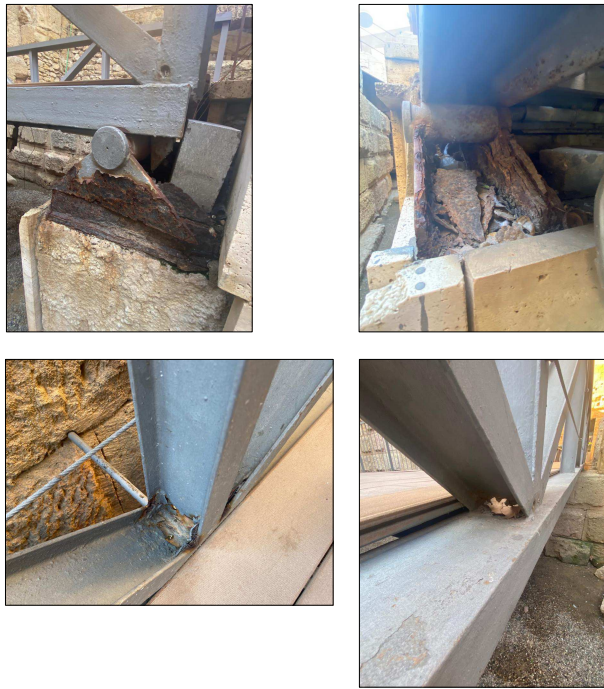
VISTES DEL DETERIORAMENT DEL NUSOS DE L'ENCAVALLADA I BASES DE SUPORT DE LA PASSERA DE FUSTA AMB ESTRUCTURA METÀL·LICA
