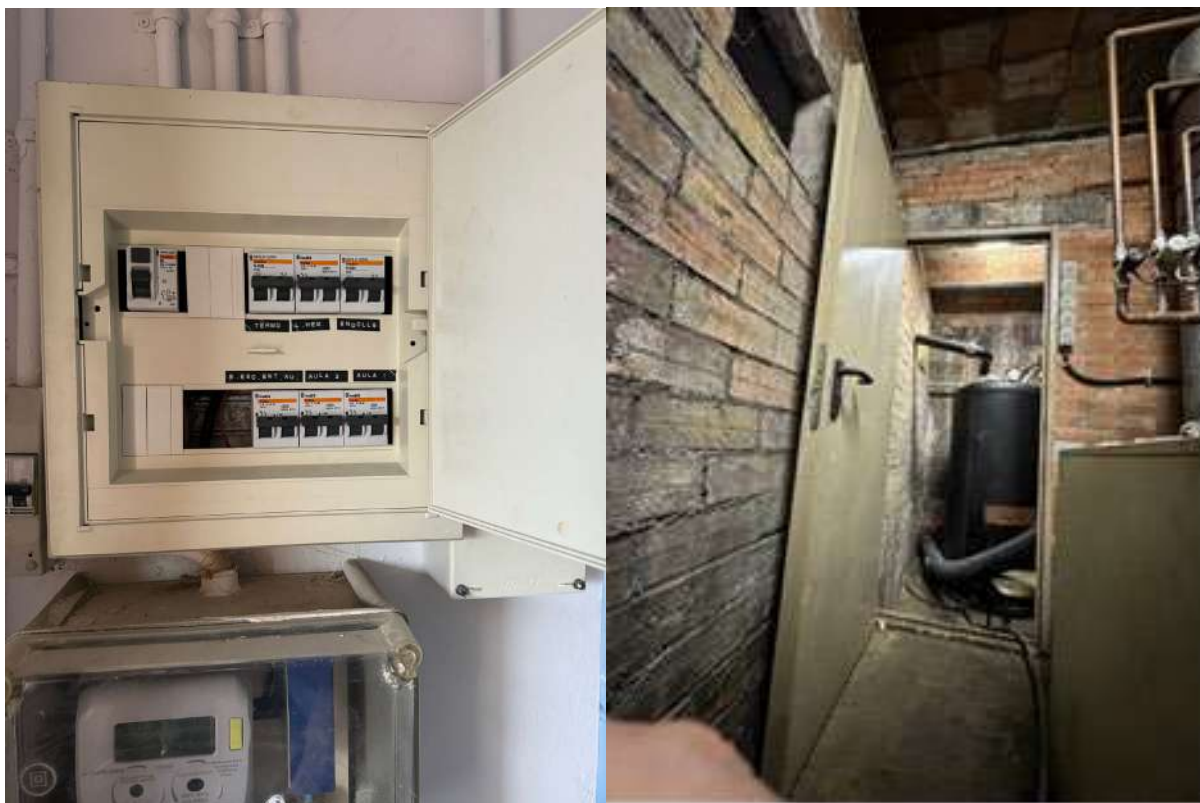
Imatge del quadre de llums i de la sala de calderes.
