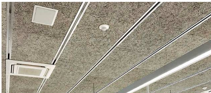
Imatge d'un fals sostre de fibres amb estructura metàl·lica en una sola direcció.
