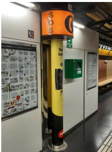
Figura 5 Columna d'un botó (SOS) d'andana
