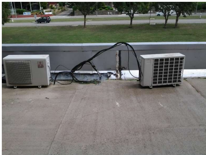
Imatge 4. Unitats exteriors (compressors) de les bombes de calor de la instal·lació de climatització de les oficines de planta primera, ubicades en coberta.
