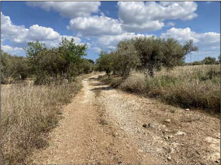
DESGAST CAPA RODADURA DEGUT A L'ACCIÓ EROSIVA DEL TEMPORAL DE PLUGES
