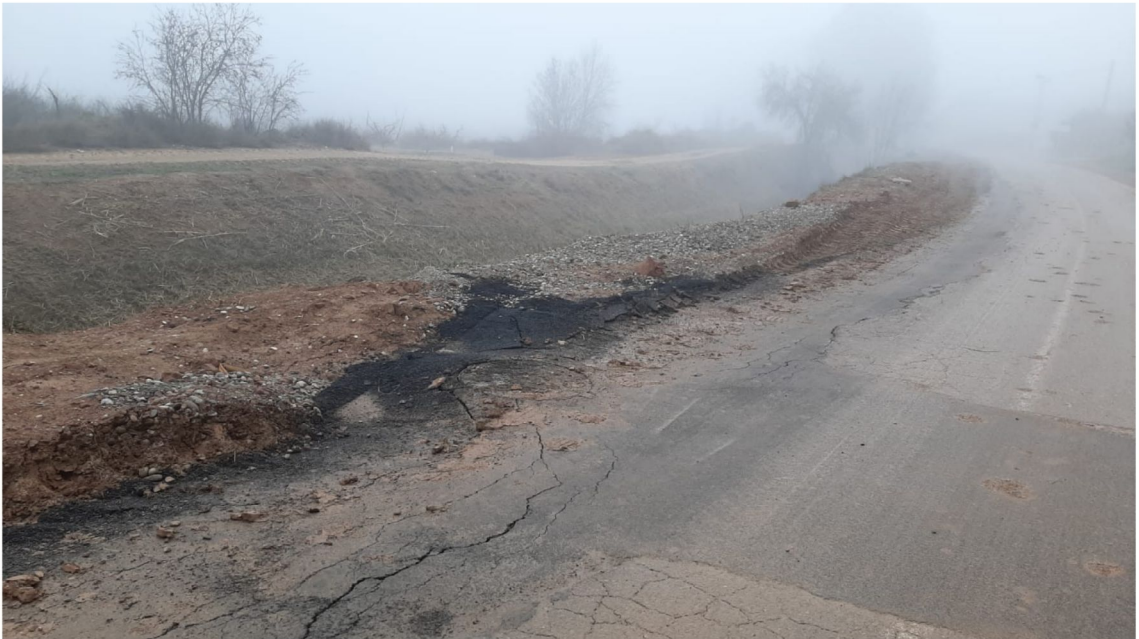
Vista de la zona lateral on el ferm està malmès a sobre del col·lector.
