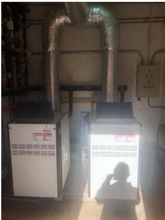
Calderes a substituir
