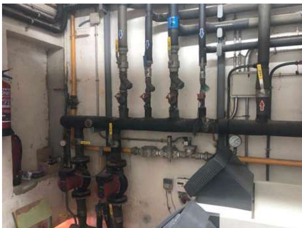
Circuits de gas i distribució calefacció
