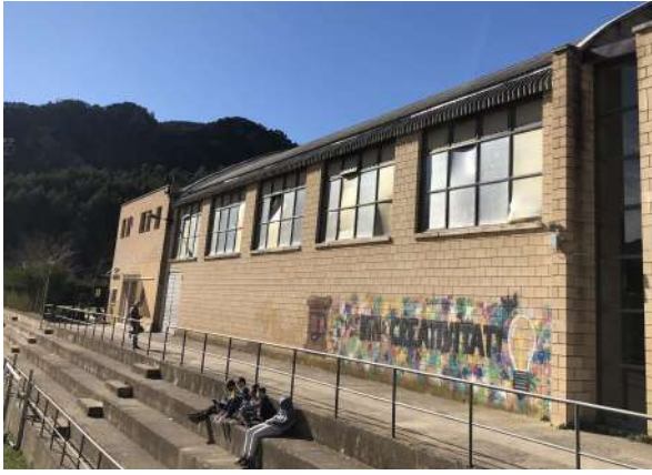
Imagen 05. Detalles del mal estado de los cerramientos.
