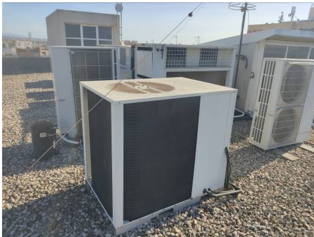
Planta coberta, màquines condensadores aire condicionat
