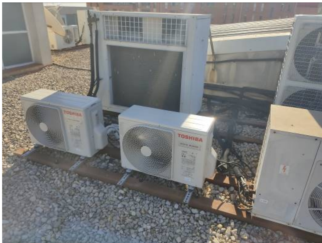
Planta coberta, condensadores aire condicionat
