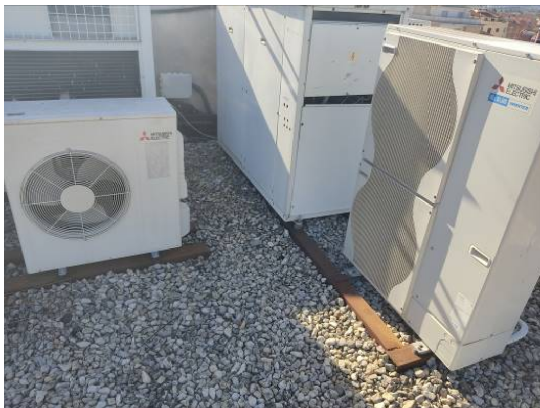
Planta coberta, màquines condensadores aire condicionat
