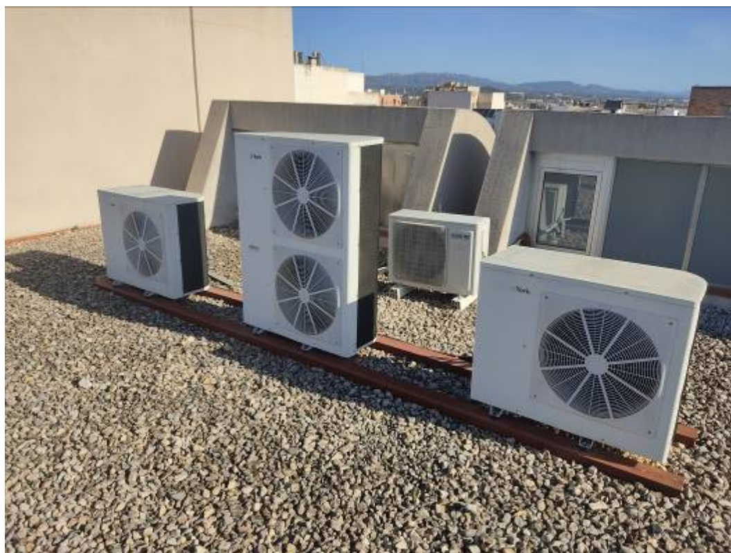
Planta coberta, condensadores aire condicionat
