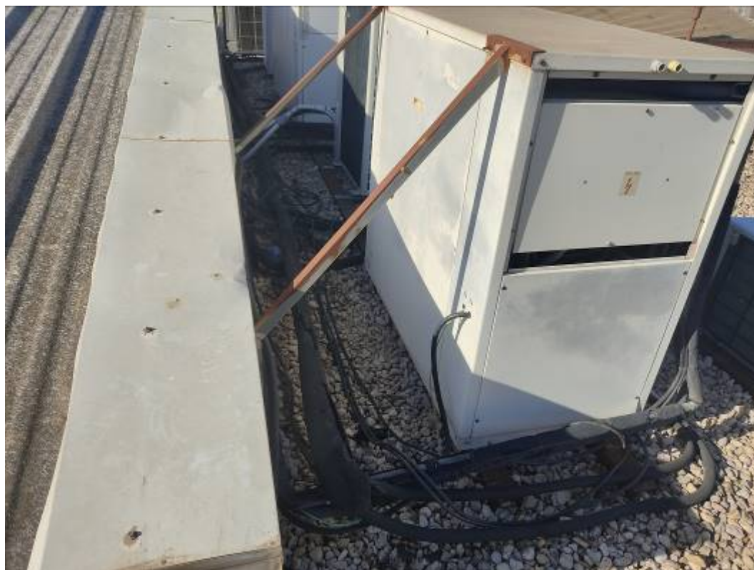
Conduccions del gas de les condensadores
