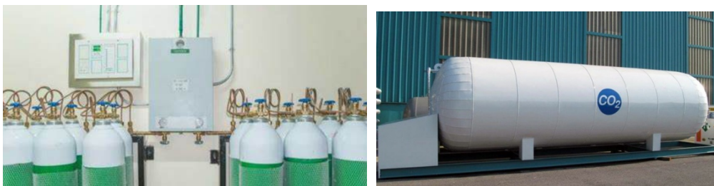
Figura 1. Exemples d'instal·lació de gasos tècnics amb ampolles i dipòsits.
