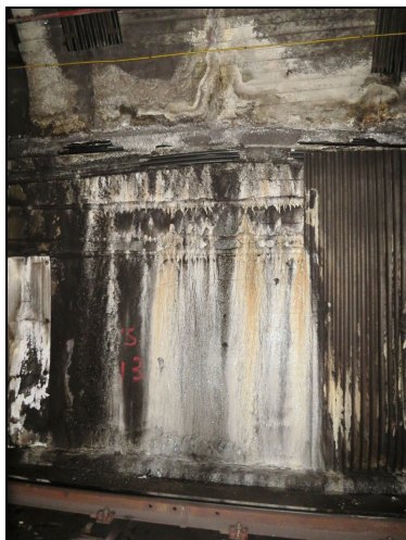
Foto 11: Filtració capcer PK 103+720 via 2
