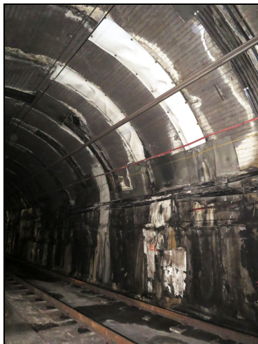
Foto 9: Filtració volta PK 103+660-760 v2.
