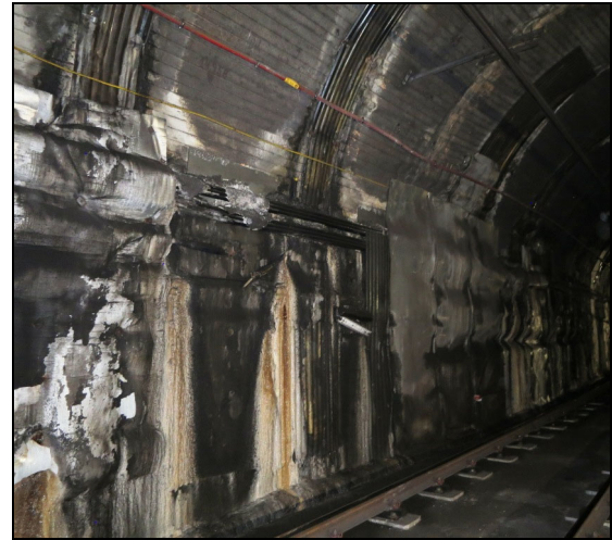
Foto 8: Filtració capcer PK 103+660-760 via 2
