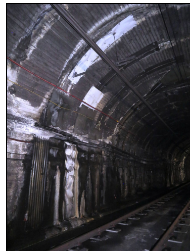
Foto 12: Filtració volta PK 103+660-760 v2.
