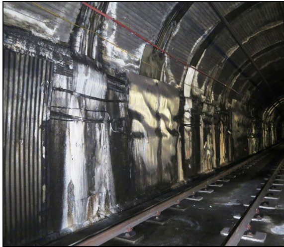
Foto 7: Filtració capcers PK 103+660-760 via 2
