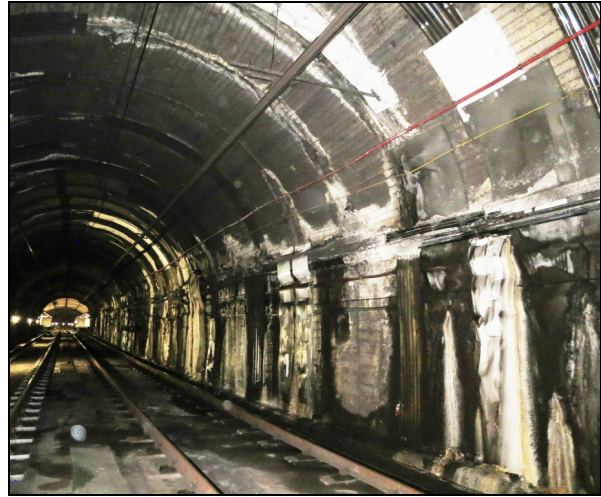
Foto 2: Vista de la secció afectada de via 2 des del PK 103+660.
