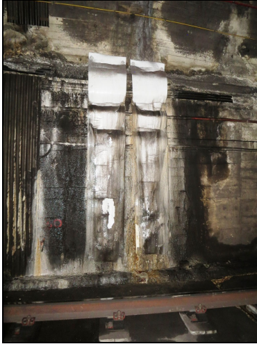
Foto 13: Filtració capcer v2.
