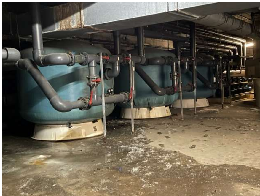
Foto2. Sala amb 3 dels 5 filtres de piscina exterior
