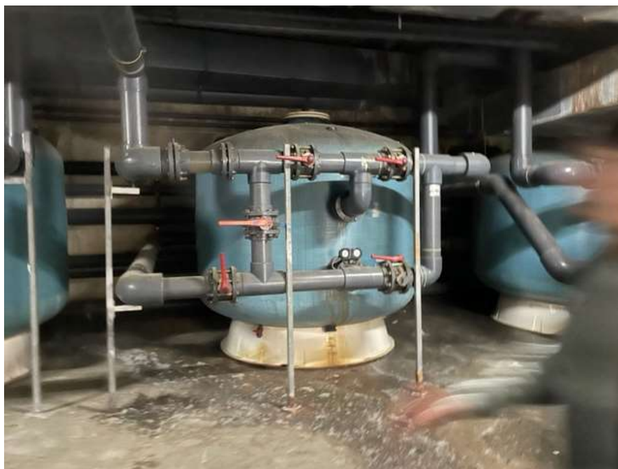
Foto 3. Filtre tipus a substituir
