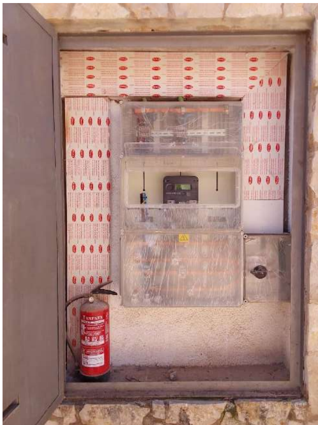
Centralització de comptadors. Ubicació nou comptador de generació neta
