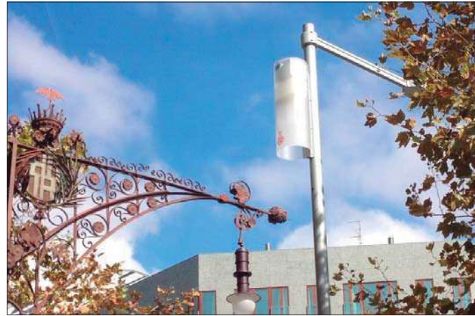
Ejemplo de instalación finalizada.
