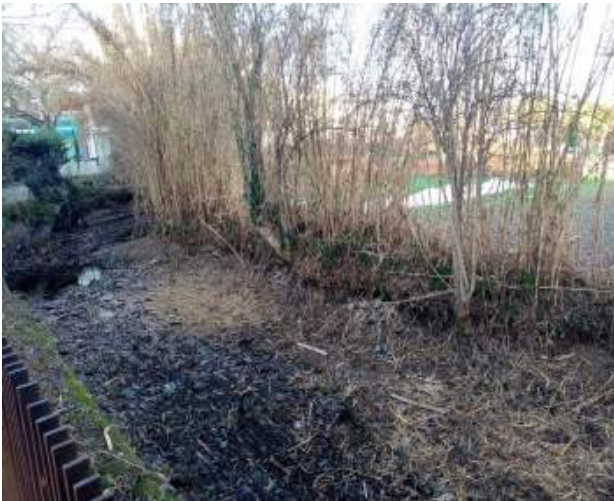
Acumulació de sediments en el peu del marge esquerre de la Sèquia.
