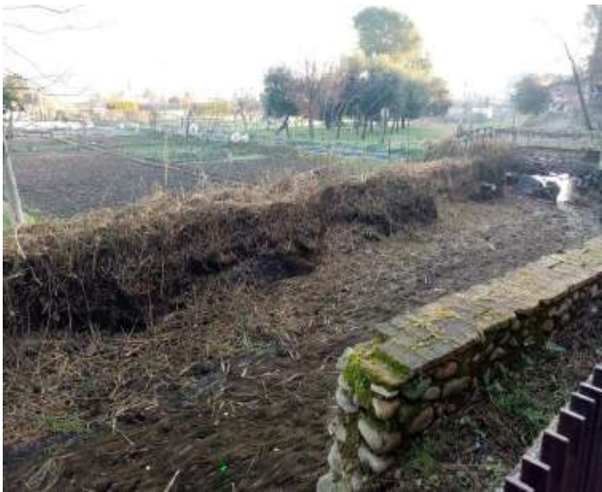
Vista del mur del marge dret de la Sèquia.
