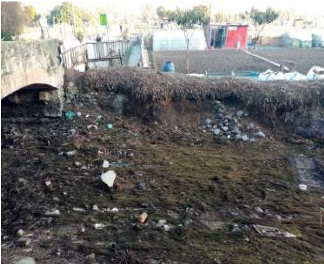
Estat del mur de còdols aigua avall del pont del carrer de Joan Roig i Jalpí.
