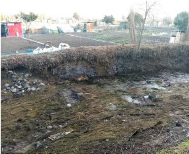
Acumulació de sediments en el peu del marge esquerre de la Sèquia aigua avall del pont del carrer de Joan Roig i Jalpí.
