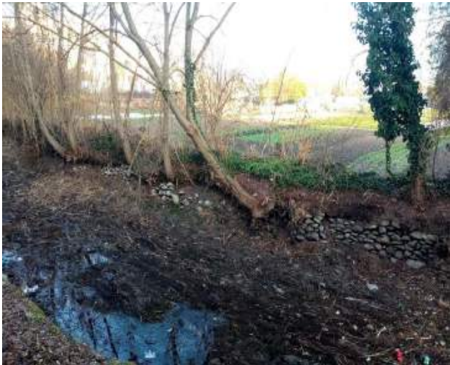
Estat del mur de còdols aigua amunt del pont del carrer de Joan Roig i Jalpi.
