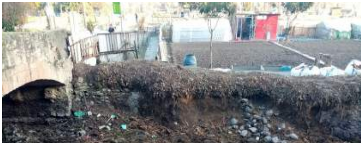
Figura 3. Estat actual del marge esquerre de la Sèquia just aigua avall del pont del carrer de Joan Roig i Jalpí.
