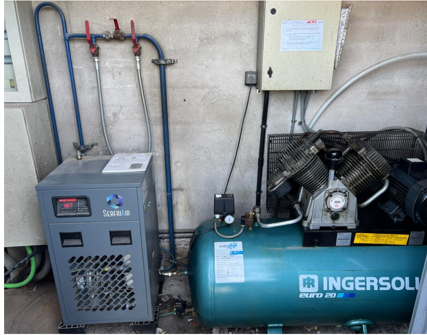
Instal·lació existent on s'observen l'assecador frigorífic, subquadre elèctric, compressor d'aire INGERSOLL RAND i dipòsit d'acumulació.
