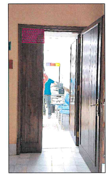
DETALL 2. Modificació de les portes. Fer una part fixa superior per on passar les línies
