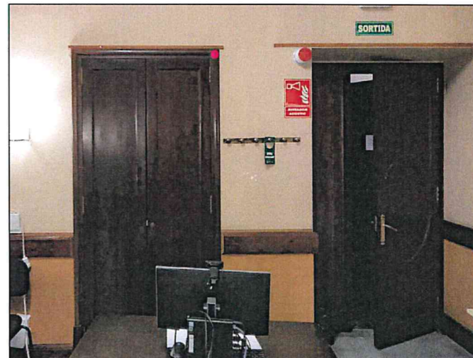
DETALL 2. Modificació de la fusteria de l'armari, deixar una tarja fixa en una de les fulles. Pas del cablejat per sota del cel del WC de minusvàlids i per dins de l'armari.
