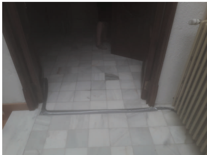
Foto 8. Estat actual del cablejat de xarxa, molt precari
