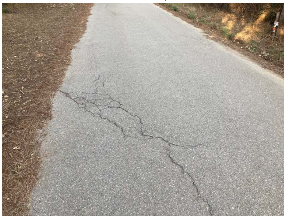
Vista d'un sector amb esquerdes superficials no estructurals
