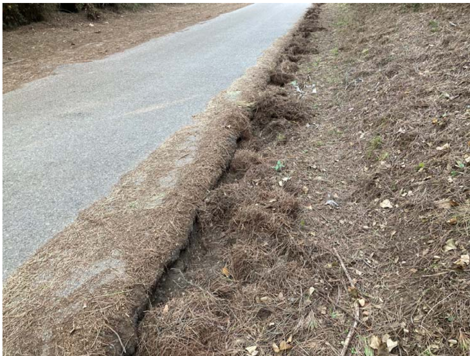
Imatge on s'aprecia el descalçament del paviment asfàltic
