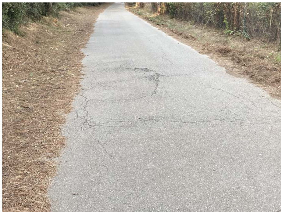
Vista d'un sector afectat per les arrels
