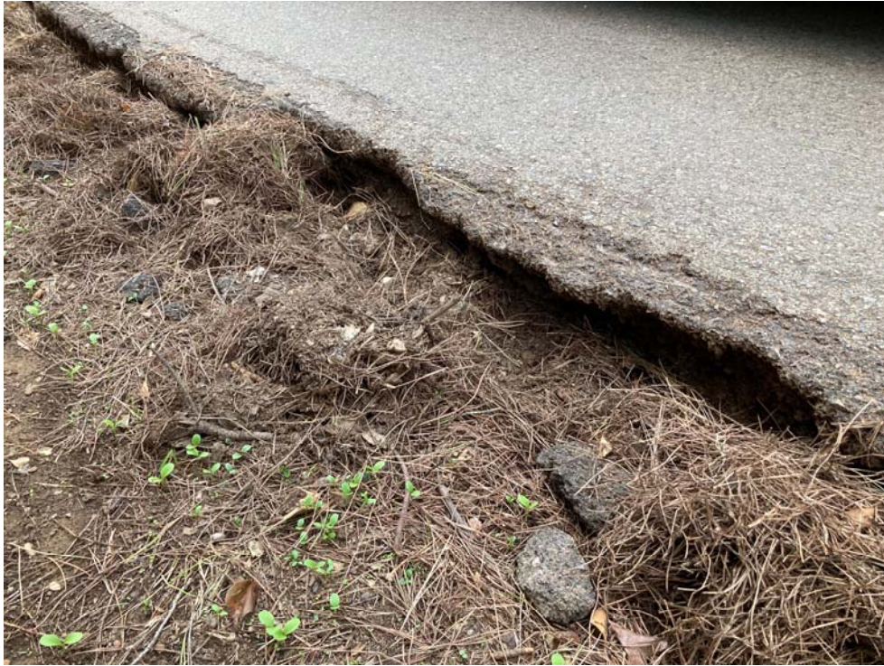
Imatge amb més detall del descalçament de la capa de paviment asfàltic
