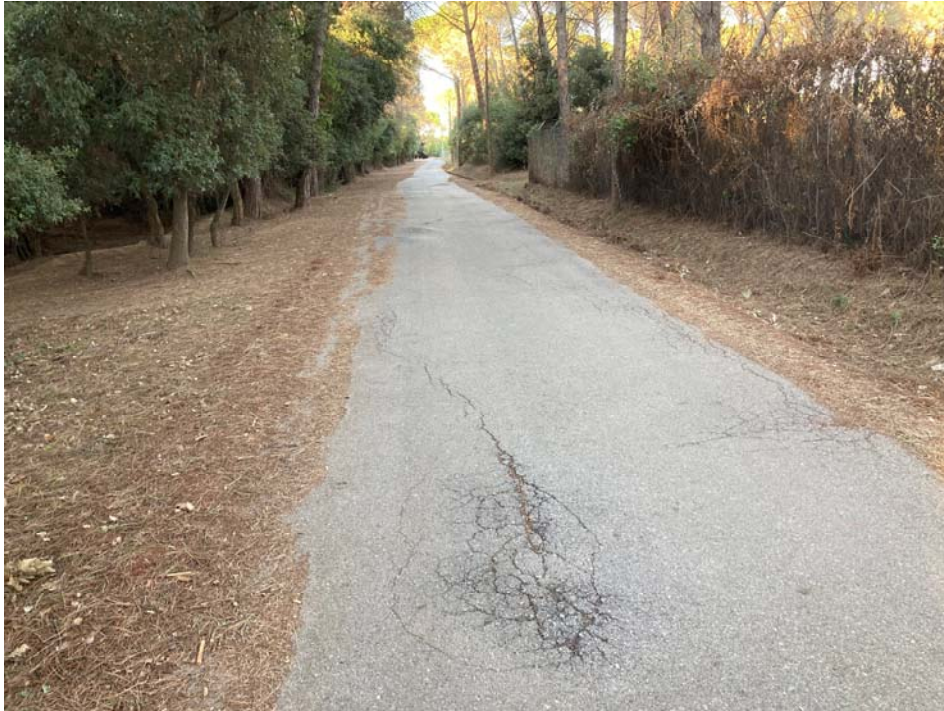
Vista d'un altre sector afectat per les arrels
