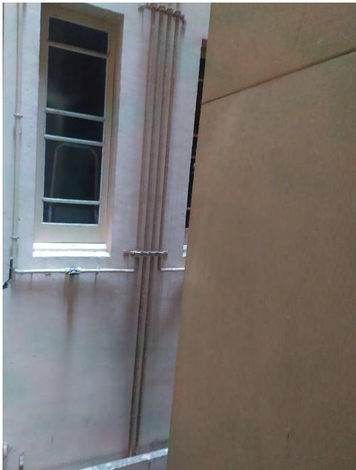
Pati 02 de ventilació
