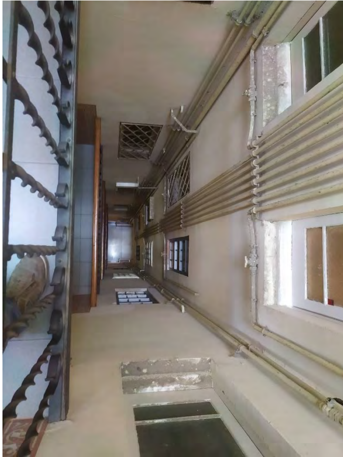
Pati 01 de ventilació
