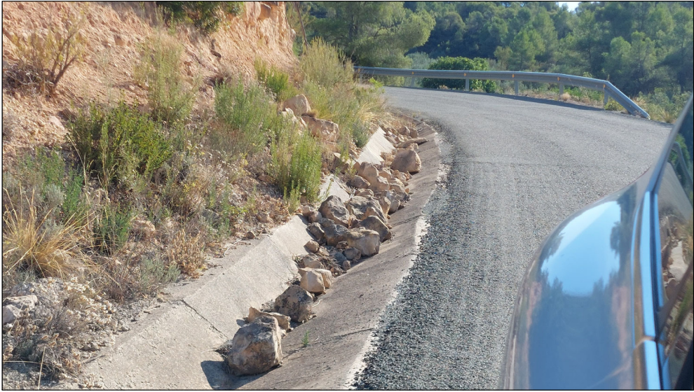
Fotografia Georeferenciada,Cuneta existent, caldrà netejar-la. pk: 3+300
