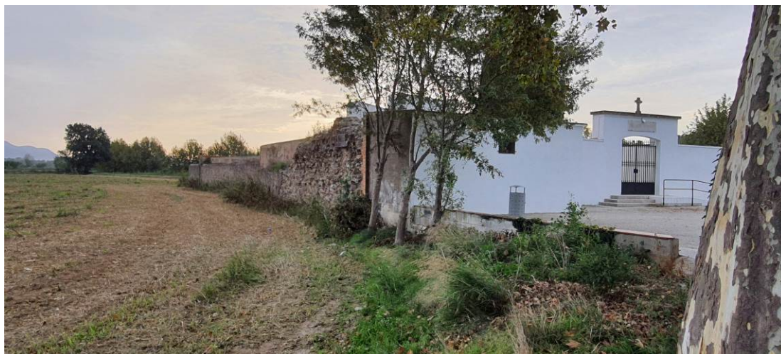
Façana nord. Problemàtica per filtracions. (parets sense revestiments hidròfugs)
