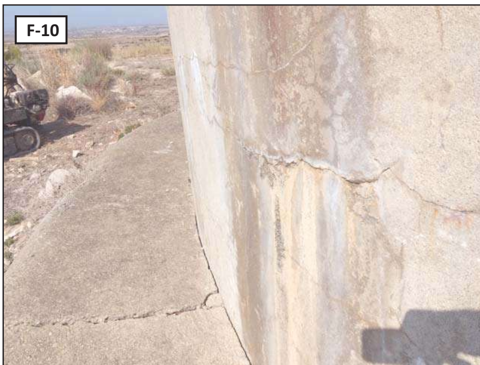
Fotografies 9 i 10: Altres imatges del dipòsit més antic on es veuen afectats per diferents patologies.
