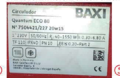
DADES BOMBA ACTUAL CIRCUIT CALOR
