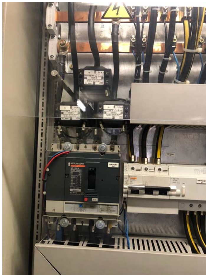
Imatge 7.- Vista Quadre Elèctric. Interruptor General
