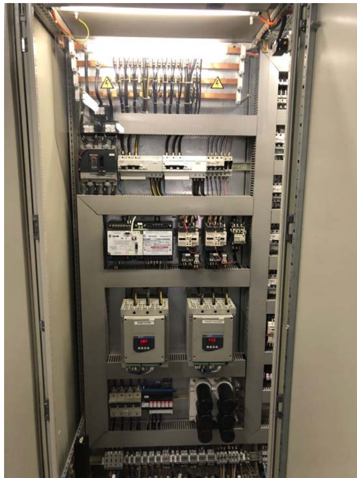
Imatge 8.- Vista Quadre Elèctric. Engegadors progressius
