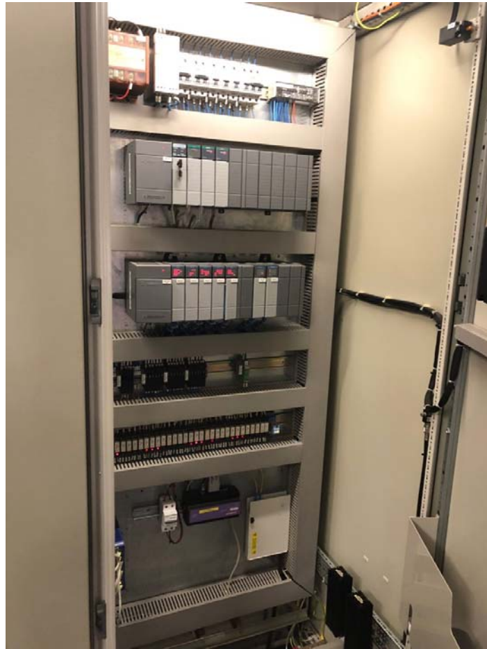
Imatge 10.- Vista Quadre Elèctric. PLC's.
