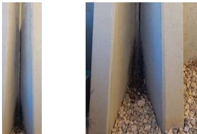
Figura 11: Fotografia de l'evidència de la permeabilitat de les juntes entre les peces prefabricades de l'espessor.
