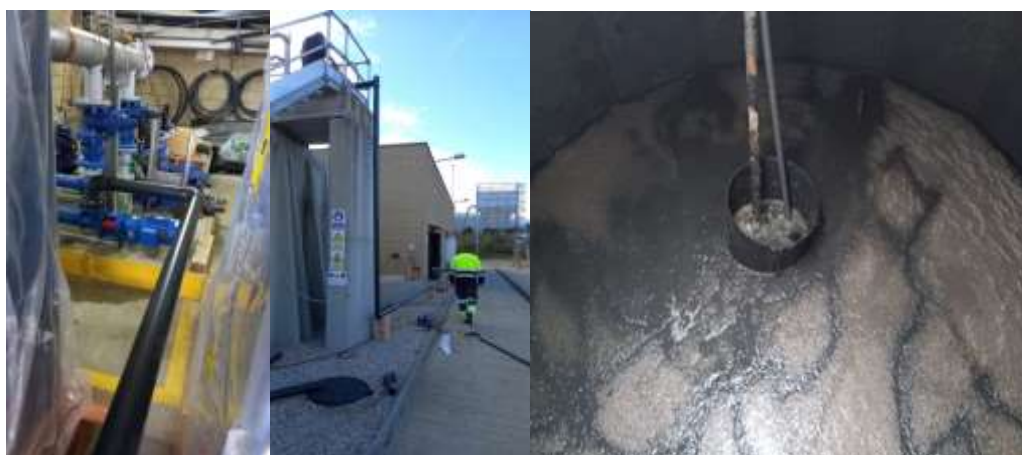
Figura 4: Recull fotogràfic de la instal·lació de bombament dels fangs i de la situació interna de l'espessidor en anar-lo buidant.
