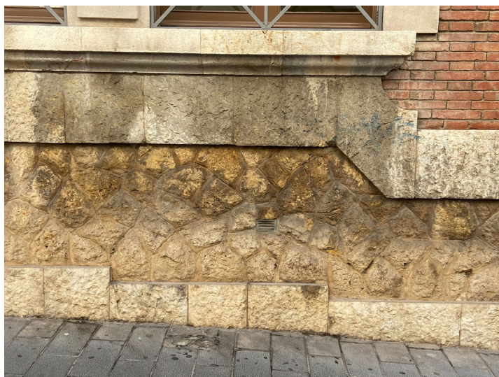
Brutícia façana zona pedra.
