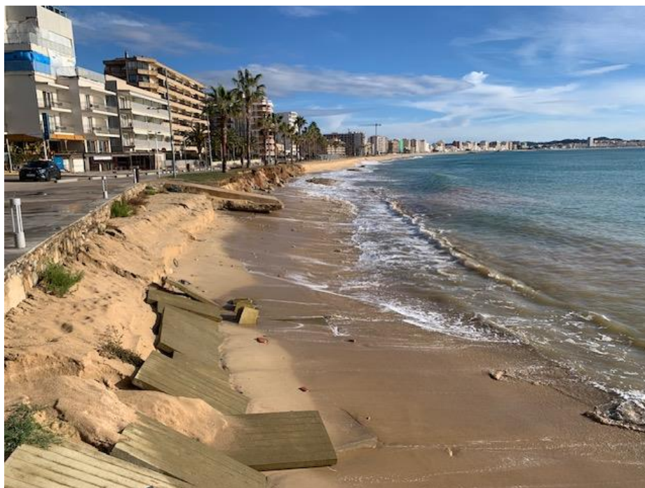
Zona de Torre Valentina amb risc de descalçament de la zona del passeig (fotografia 2).
