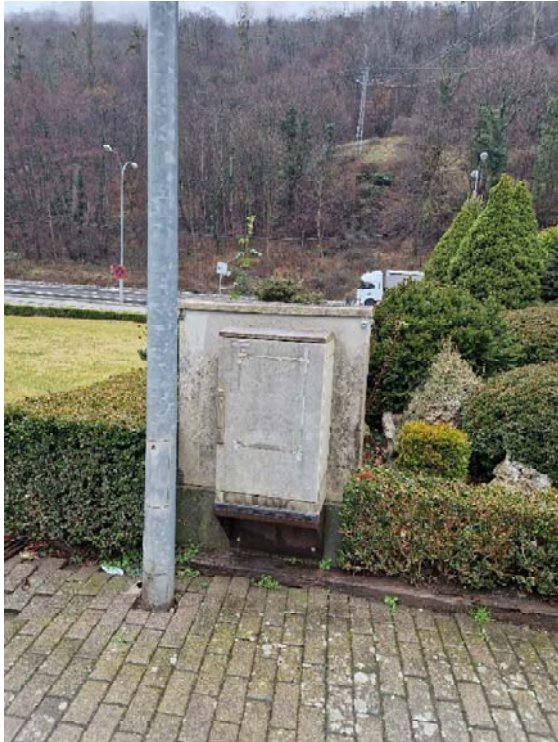
Imagen 08. Cuadro de mando Q12 – Carretera A-14 Escamun
