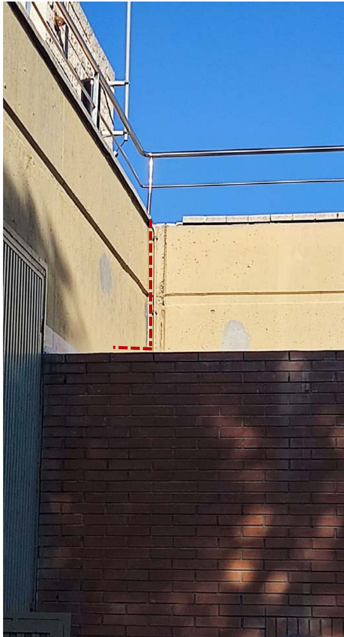
Figura 10.- Proposta de recorregut del cable CC per entrar a sala de bombes.
