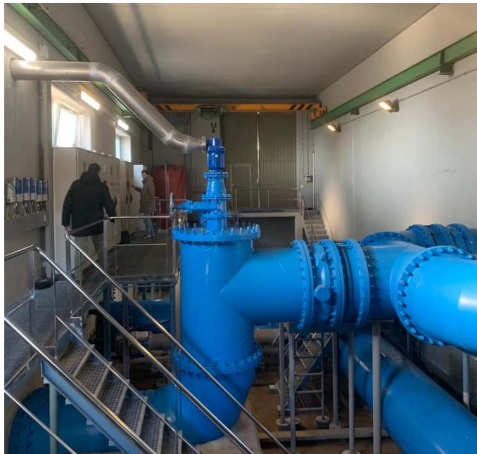
Figura 6.- Vista sala de bombament i CGBT.
