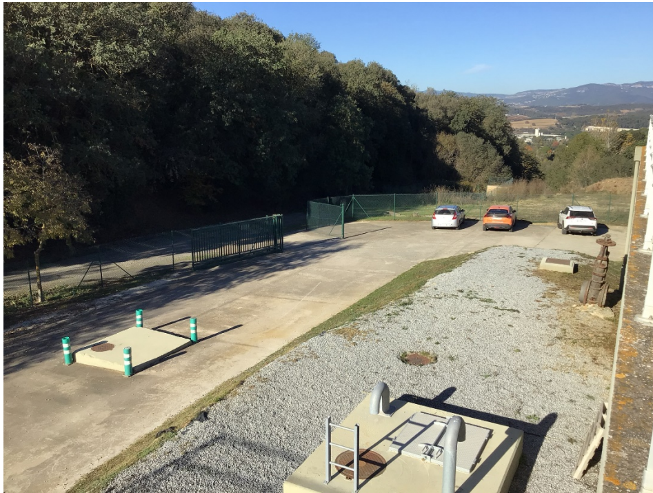
Fotografia 5 – Ubicació Centre de Transformació i Mesura
