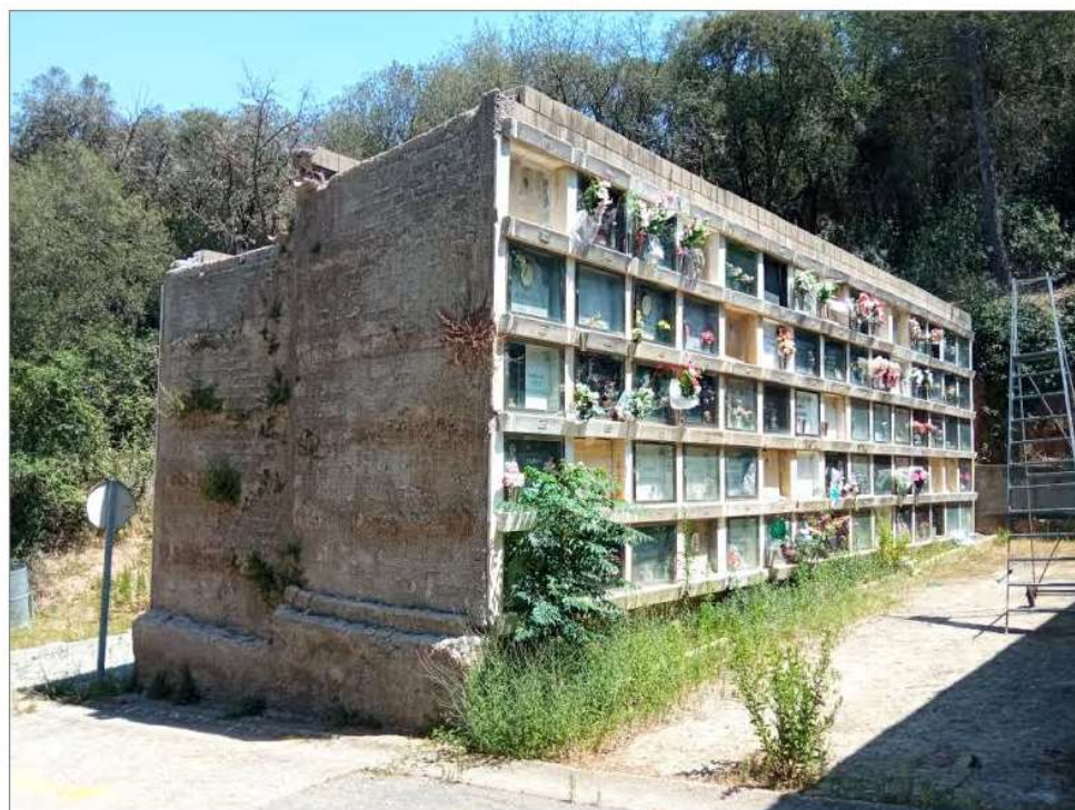
Bloc 64A09 (mal estat envoltants, coberta, fonamentació)
