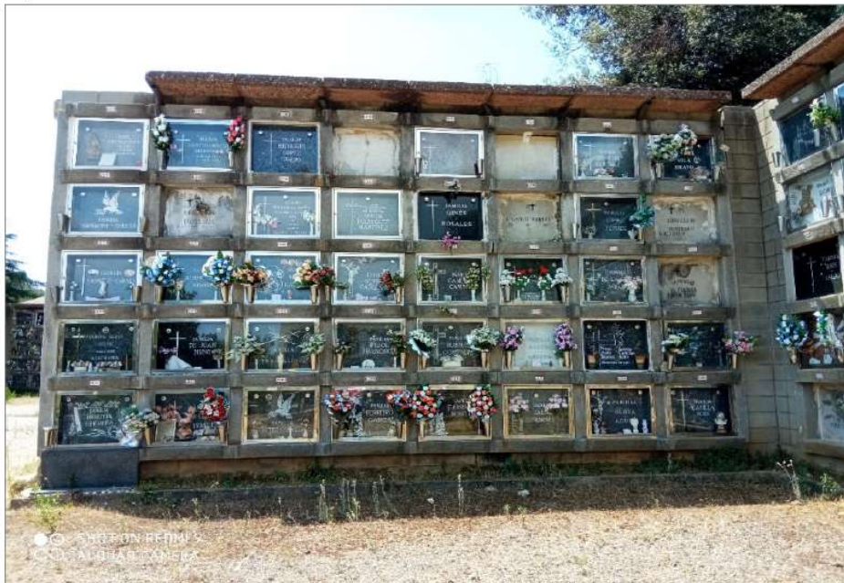
Bloc 177AA16 (moviments fonamentació, mal estat general)
