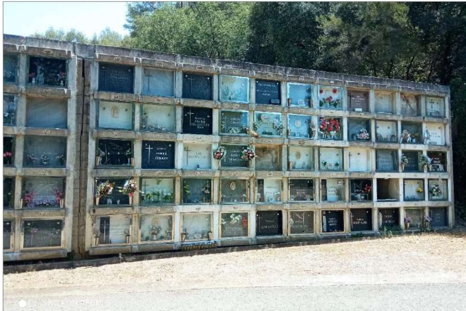
Bloc 30A07 (mal estat general, bloc "partit")
