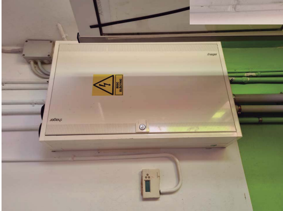
Quadre elèctric existent a la planta baixa
