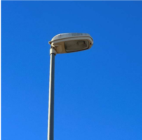
Fotografia 3. Luminaria vial tipo SOCELEC /IPSO 150W VSAP
