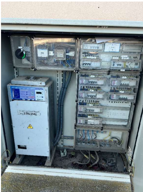
Fotografía 10. Cuadro mando y protección alumbrado tipo
