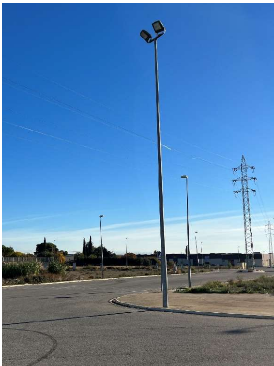
Fotografia 8. Punto luz intersección C. Industria - C. Boira. Columna 12 metros con 2 proyectores SOCELEX / NEOS S3 250W VSAP
