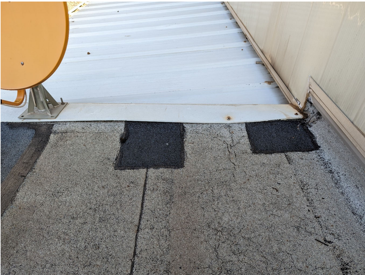
Solapament de perfil metàl·lic de remat amb la làmina autoprottegida mal segellada.
