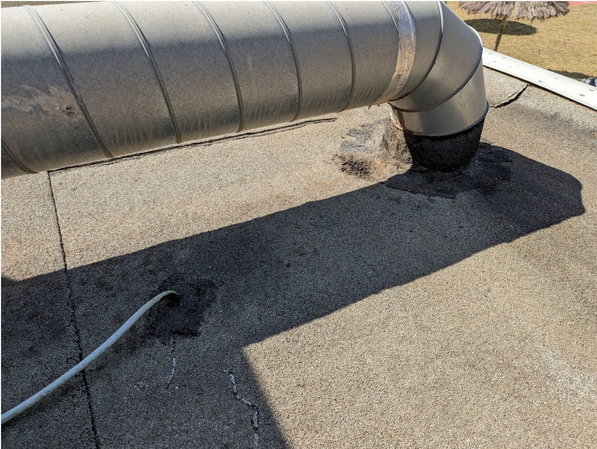
Els solapaments de la làmina autoprottegida en els passos d'instal·lacions està molt deteriorada.
